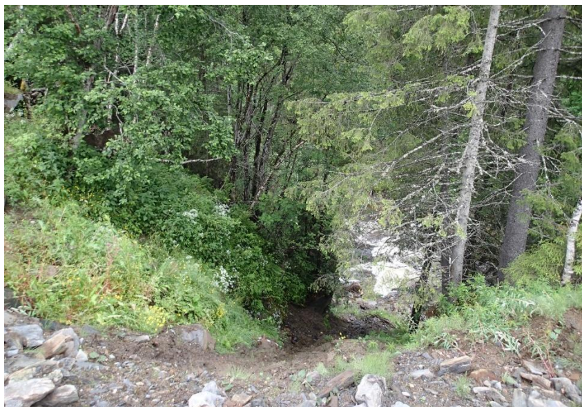
Figur 11 Erosjon i vegetasjonssone i skråning mellom elva og veien på nordsiden av elva.
