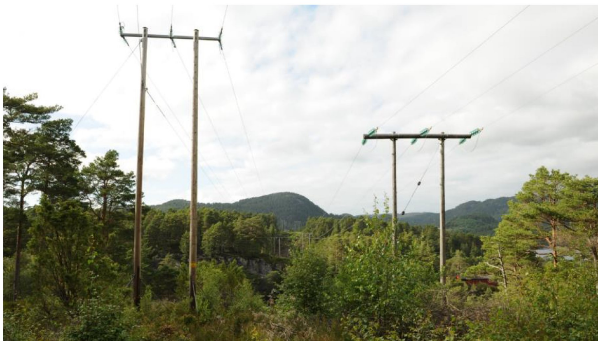
Figur 4-21 Eksisterende ledninger ved Selvåg. Ledningen nærmest fjorden til høyre på bildet skal rives når ny bygges.
