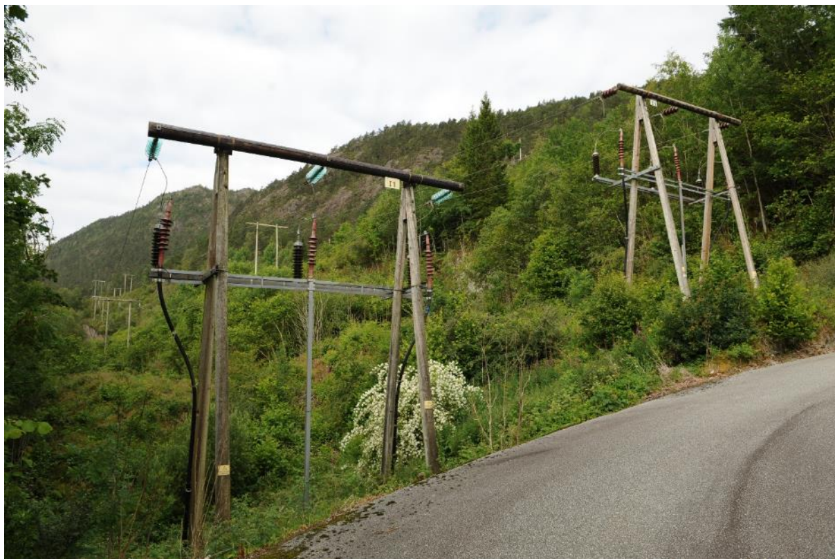
Figur 3-4 10 ledninger møtes ved Langeland transformatorstasjon. Ryddegater i skogdekte ller setter sitt preg på landskapsrommet.
