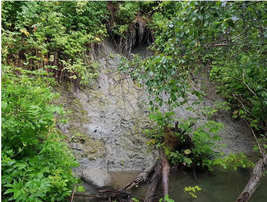
Figur 5: Overflateglidning ved høyre elvebredd. Årsaken er drenerør.
