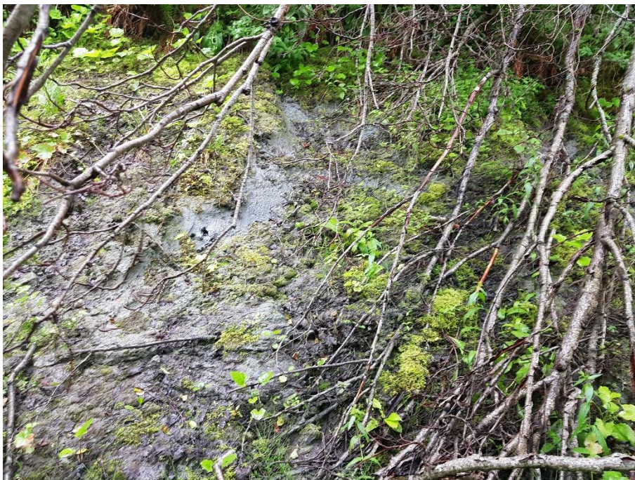
Figur 11: Overflateglidning på ca. 10 m i skråningen på venstre elvebredd.
