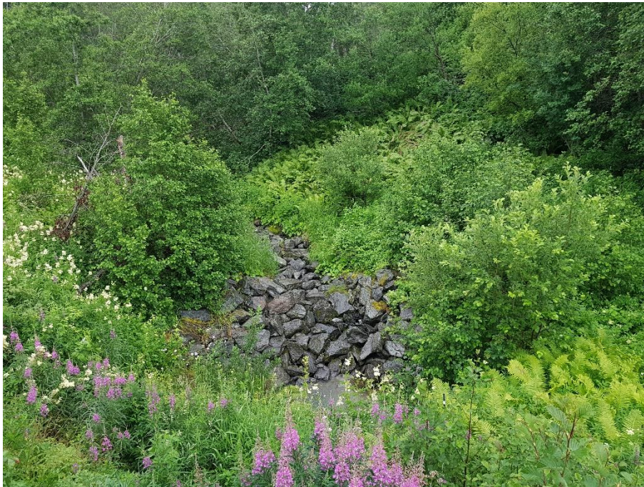
Figur 7: Kulvertinnløpet med stor stein.
