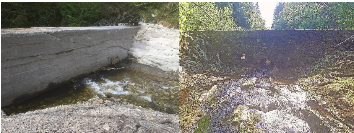
Bilde nr. 20 Dam Kvia. Bilde til venstre oppstrøms side med på støpt betong ca. 1990. Bilde til høyre viser nedstrøms damside med to åpninger.
