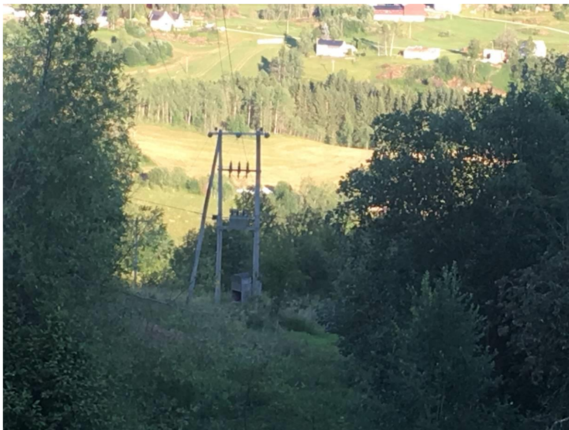
Bilde 6.1 22 kV kraftlinje like ved stasjonen
