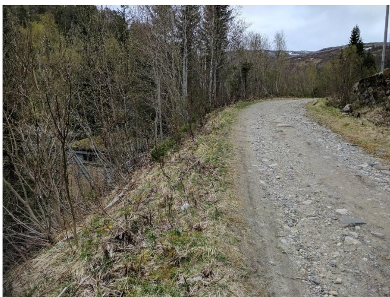
Figur 19. Vannveien ligger i eller rett ved grøften til en eksisterende skogsbilvei. Det nye røret vil kunne legges rett ned i den gamle traseen, boltes til fjell og tildekkes av stedege masser.
