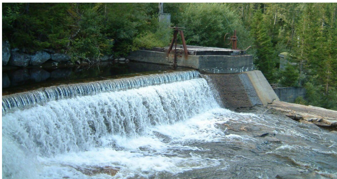
Figur 5. Eksisterende inntaksdam med tappeluke: Inntaksdam vil bli reparert/ombygget for å sikre slukeevne og sikre passasje av opp- og nedvandrende anadrom fisk.
