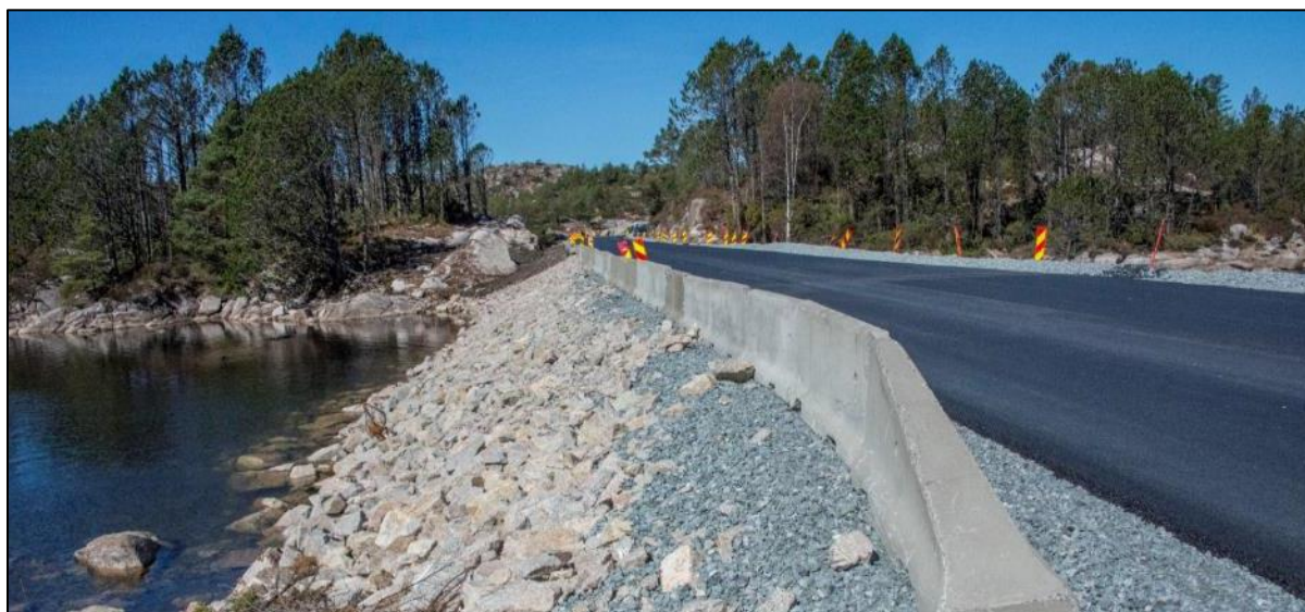
Figur 1. Fylkesvei 19 Rolvsnesvegen er nylig hevet med over en meter.
