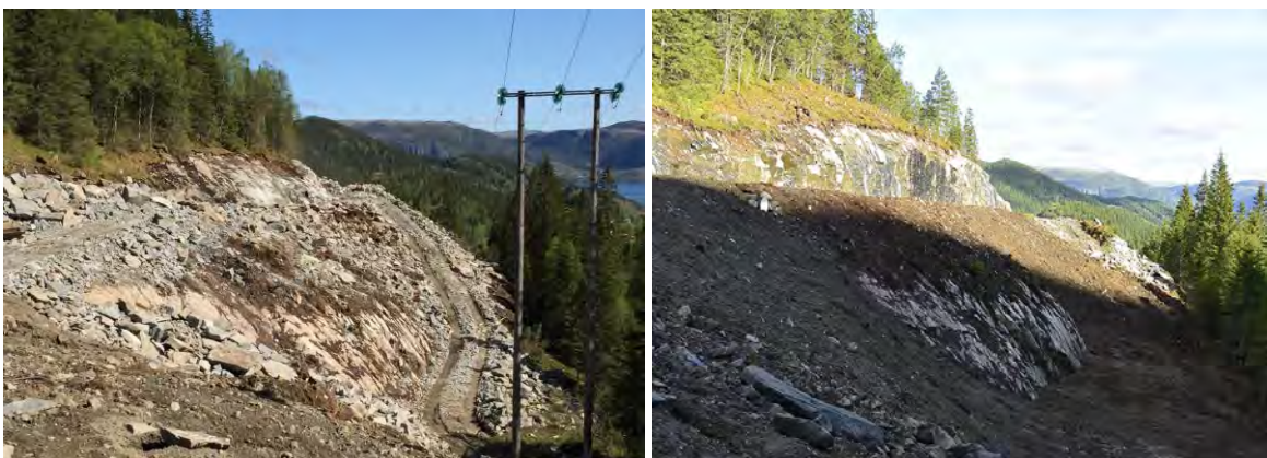
Bilde 2 Under åpning av terrenget kom en fin fjellformasjon frem i dagen. Ved å ta vare på den og tilpasse terrenget inn mot denne unngikk man en utstrakt fylling i dette punktet.
