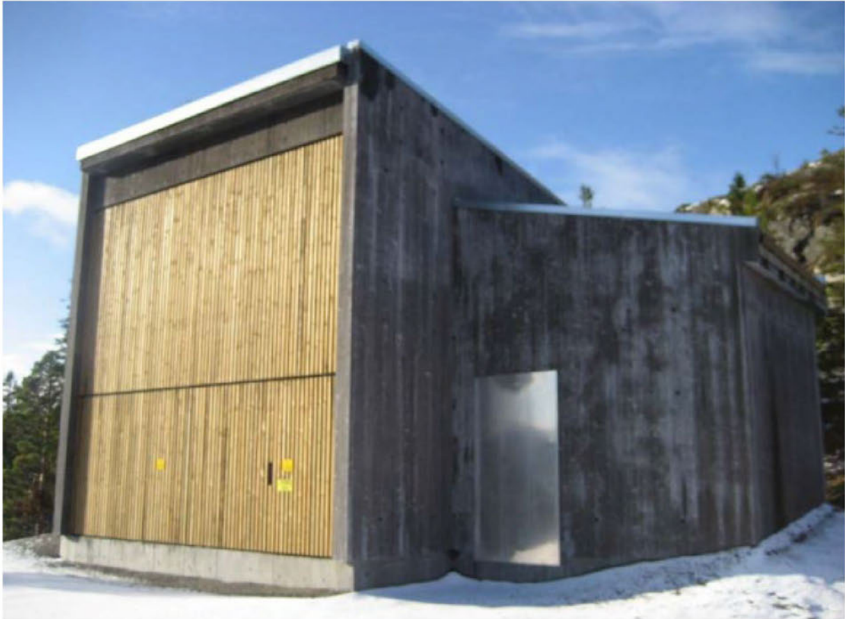
Figur 13. Eksempel på transformatorstasjon fra Bessakerfjellet vindkraftverk
