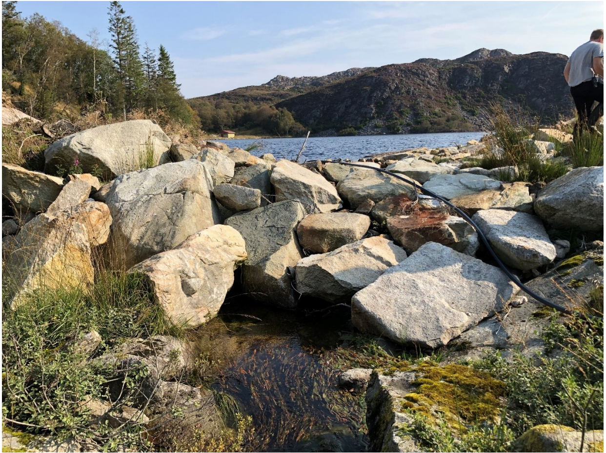
Dammen ved utlaupet av bekken frå Torlandsvatnet. Biletet er tatt av NVE under inspeksjon 28.8.2019.
