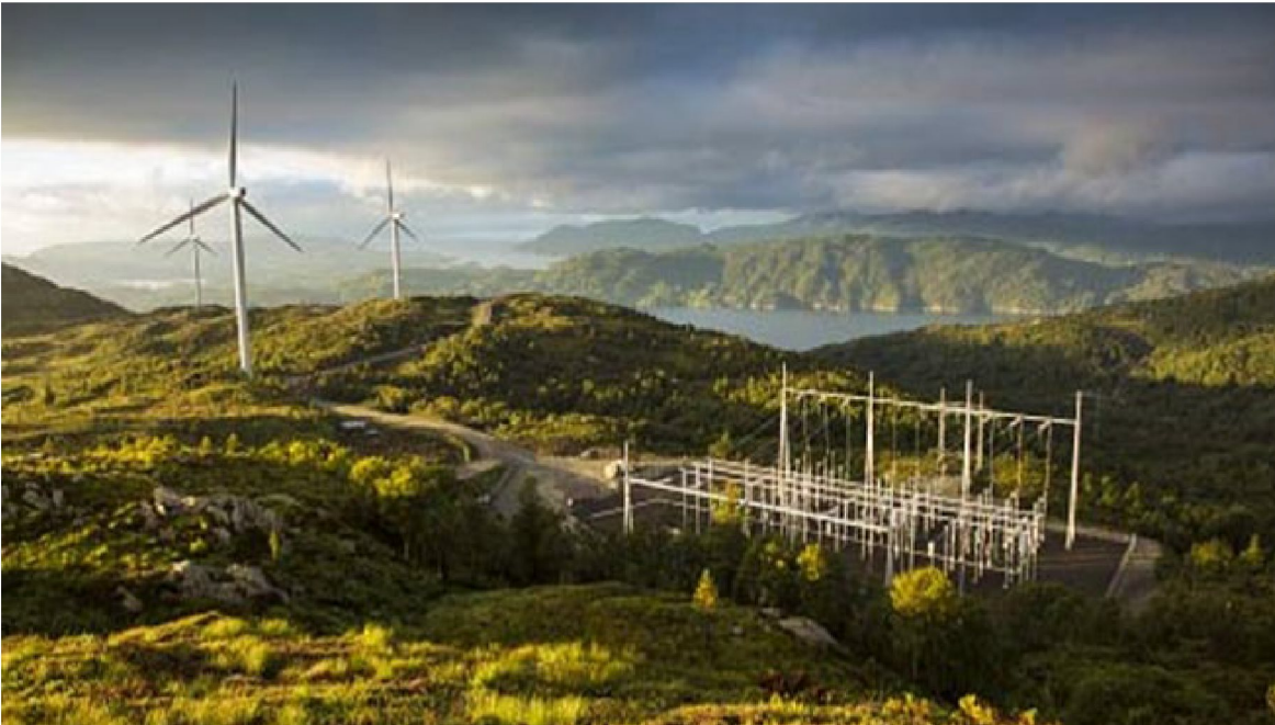
Figur 5.2 – Midtfjellet 1, 2 og 3 med transformatorstasjon
