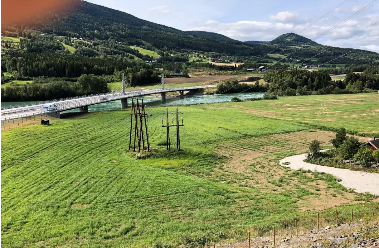
Kabelendemast ved NSBs endemast til omformerstasjonen. Eksisterende 66 kV kommer som luftledning inn fra høyre og fortsetter i jordkabel ut til venstre bildekant.
