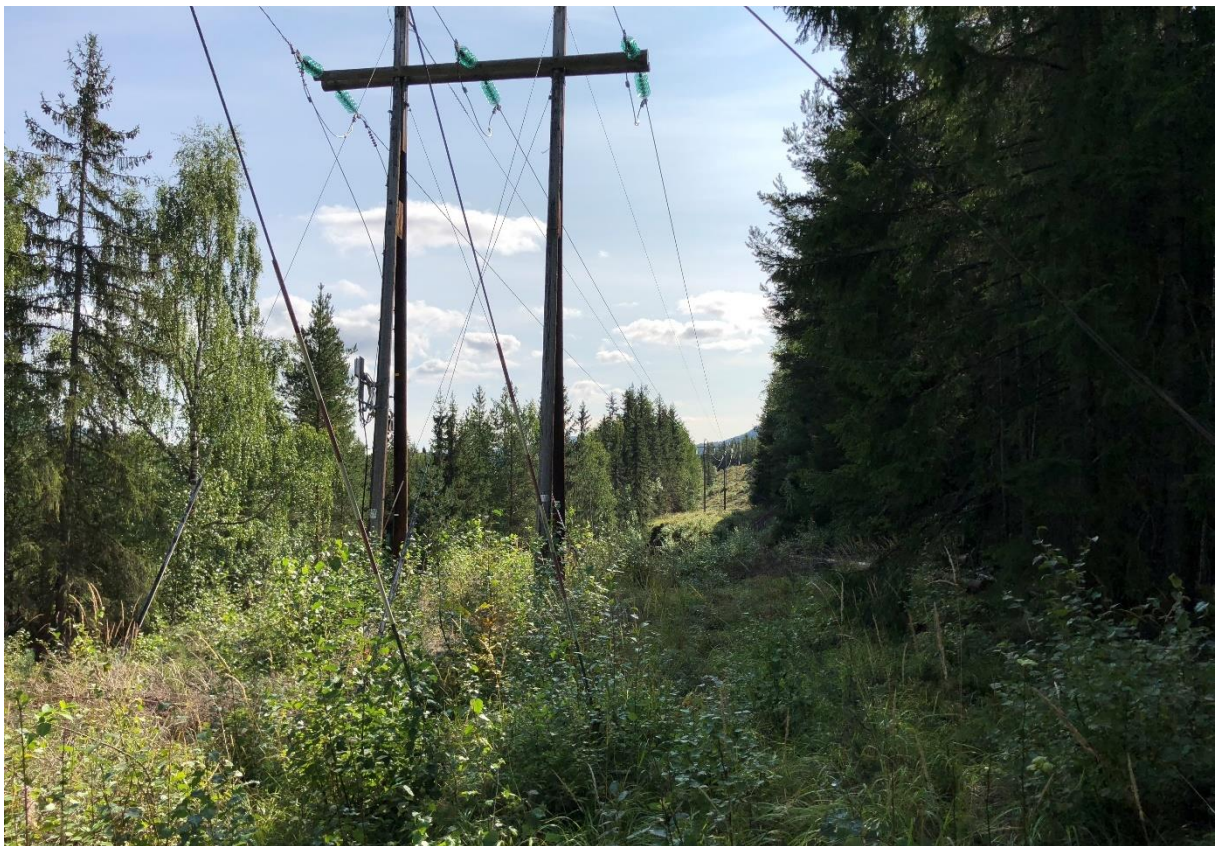
Eksisterende ledning gjennom Hardvollsmorka.
