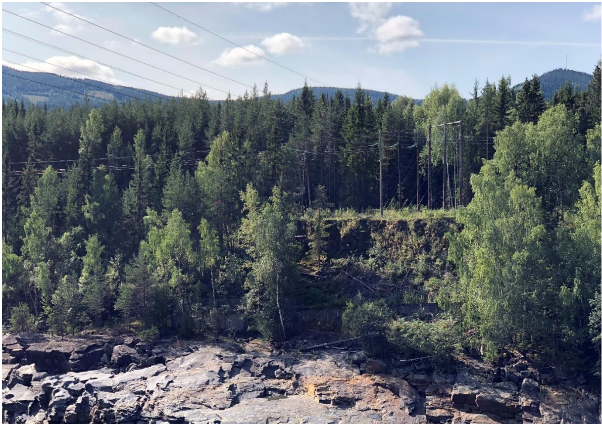
Eksisterende 66 kV krysser Lågen like nedstrøms Dam Harpefoss. Skogsområdet på andre siden av elva er Hardvollsmorka.
