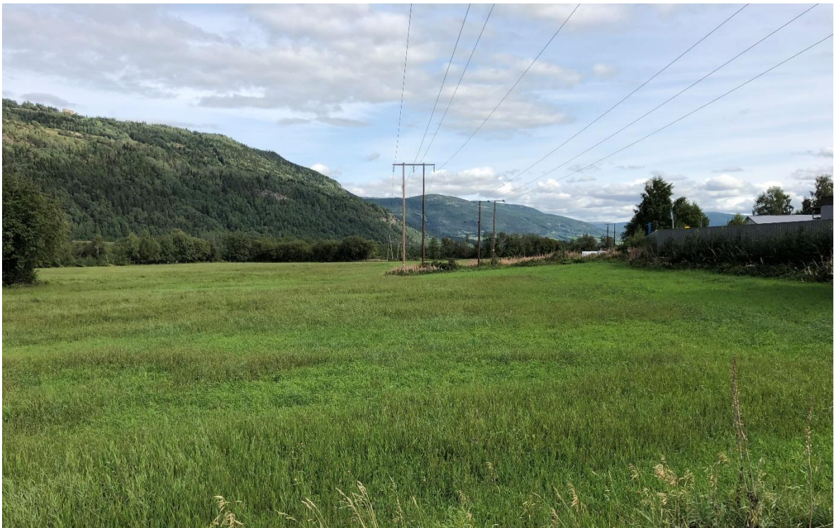
Eksisterende 66 kV parallellført med 22 kV.
