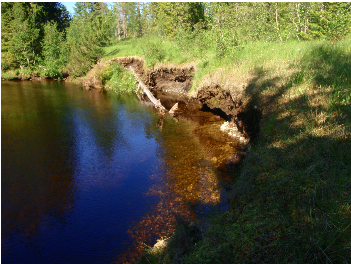
Figur 7 Erosjon langs elvebredden, ved Holmen ca kote 147.
