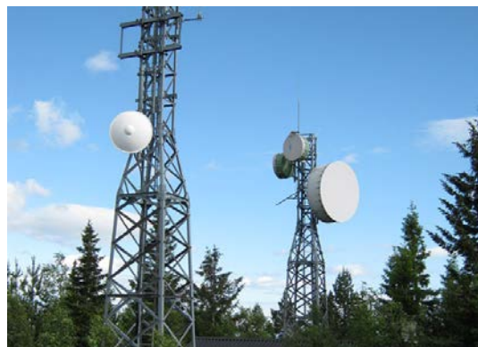
Bilde 1: Direktive antenner brukt til radiolinjer (Kilde: https://no.wikipedia.org/wiki/Radiolinje nedlastet: 26.02.2018)
