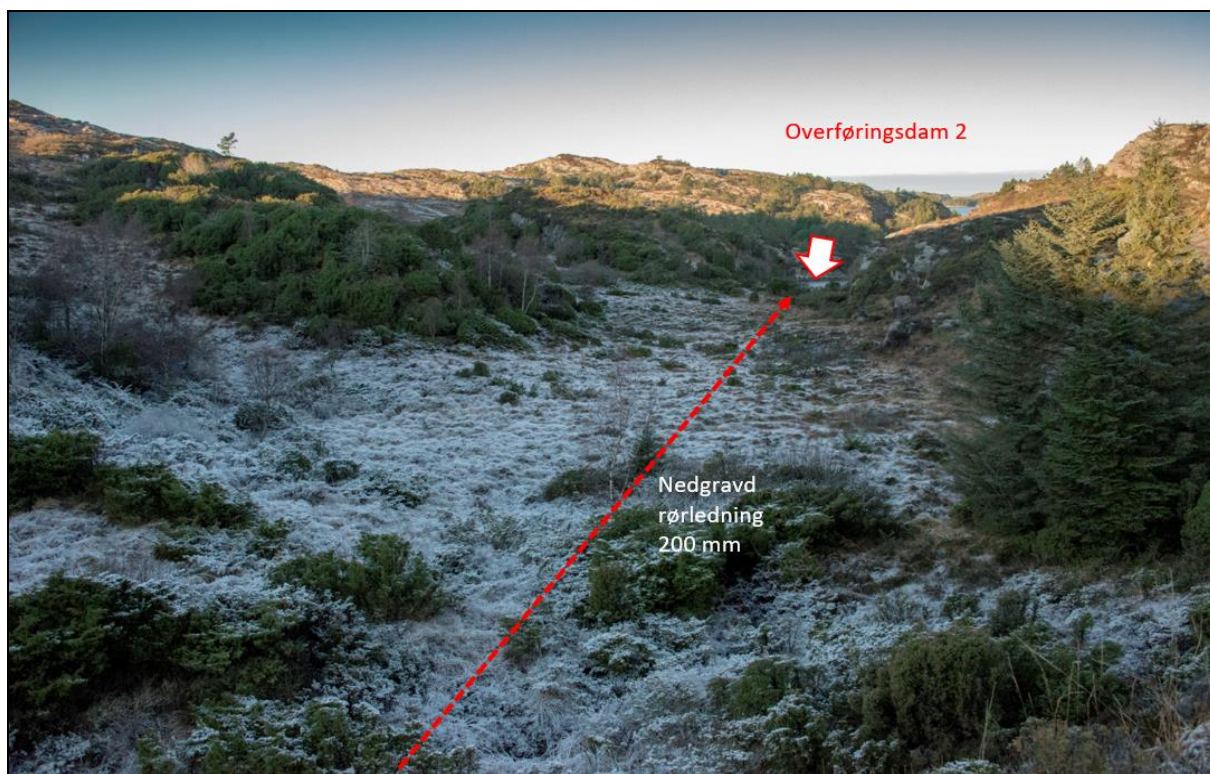
Figur 10. Nedgravd rørledning fra borehull til overføringsdam før Blandingsvatnet. Dammen ligger i et nokså trangt og bratt område nedenfor myrene på bildet.
