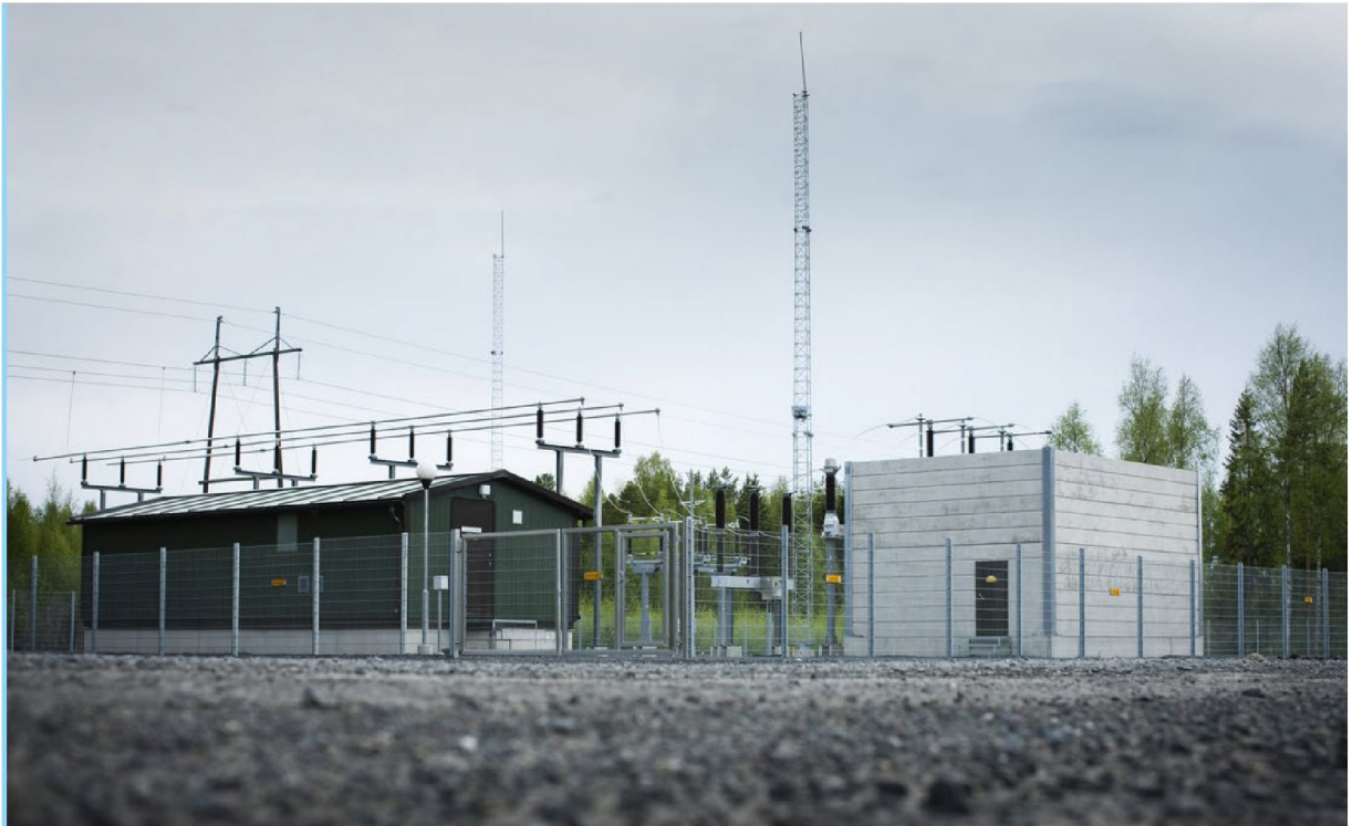
Figur 20 - Eksempelbilde, kontrollbygg, transformatorbygg og koblingsanlegg (Kilde: VEO AS)
