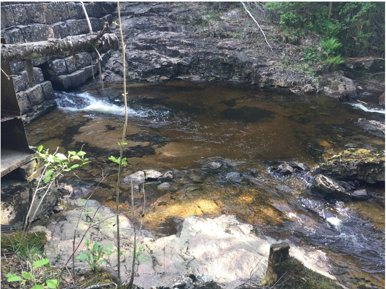
Figur 5 Mølledammen med bunntappeløp og turbinløp sett fra luftsiden
