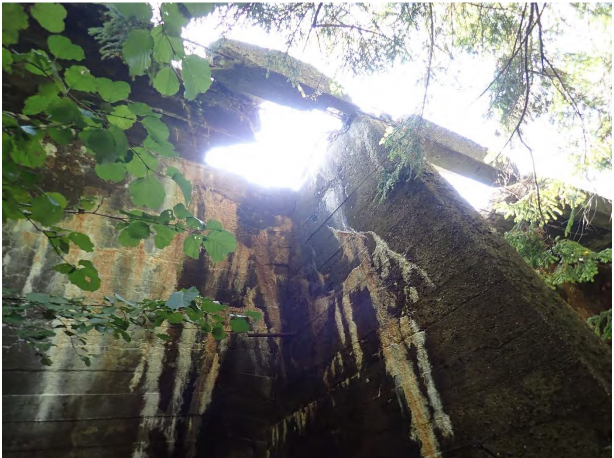
Figur 14. Skader på damkrone sett fra nedstrøms.
