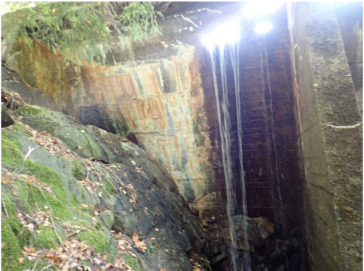
Figur 8. Skader på damkrone sett fra nedstrøms.
