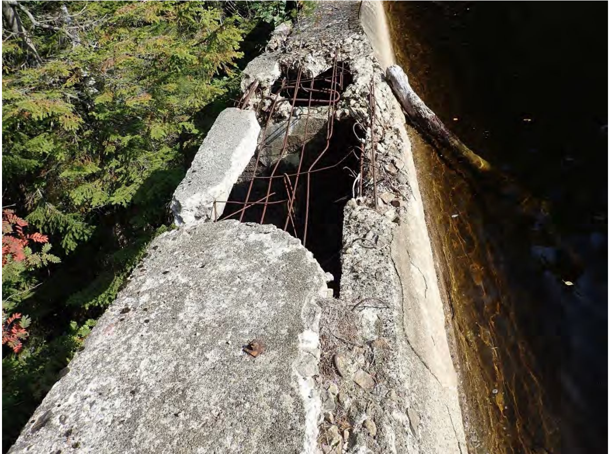
Figur 5. Skade på damkrone.
