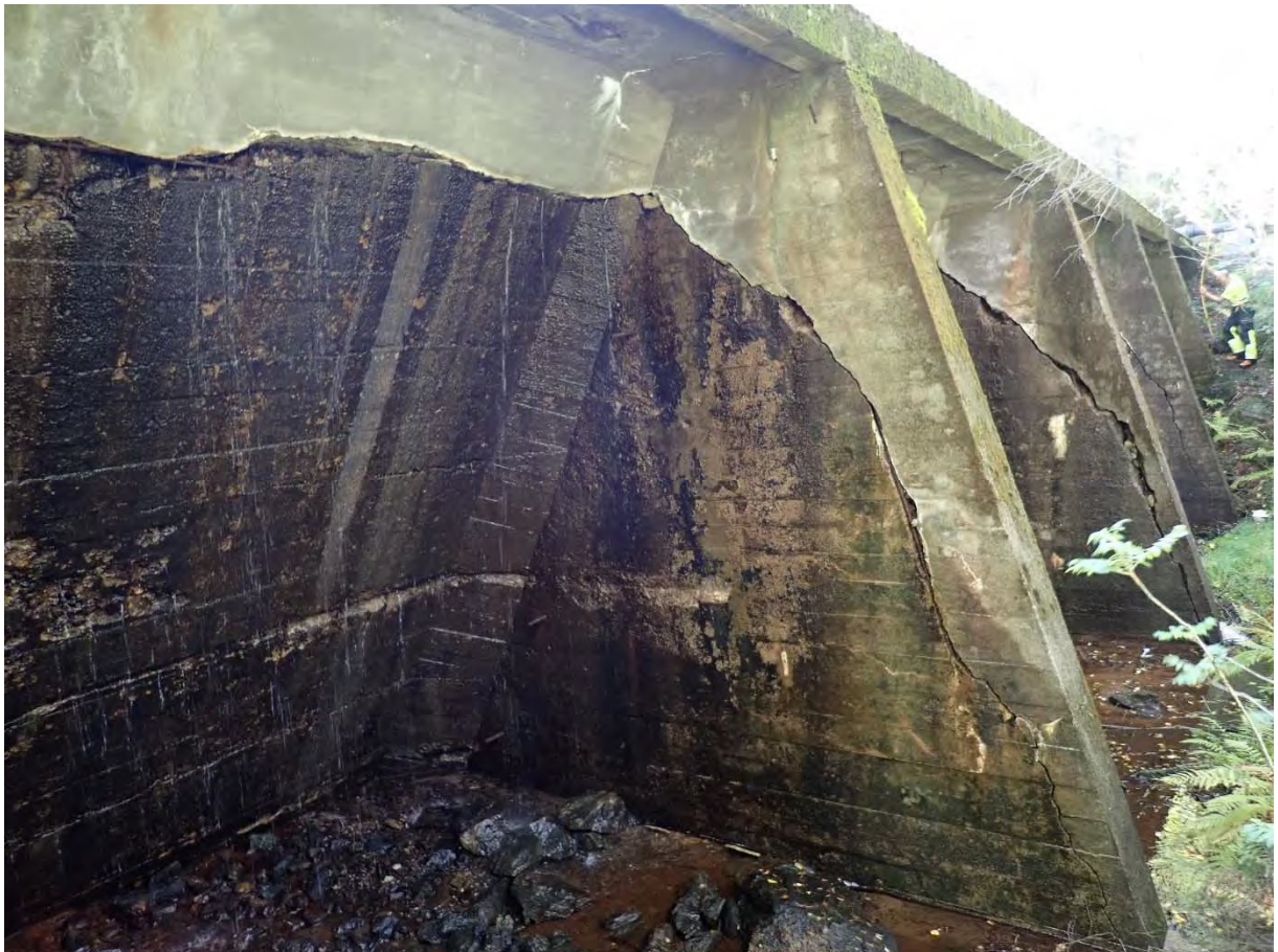
Figur 16. Skader på damplate og pilarer sett fra nedstrøms.
