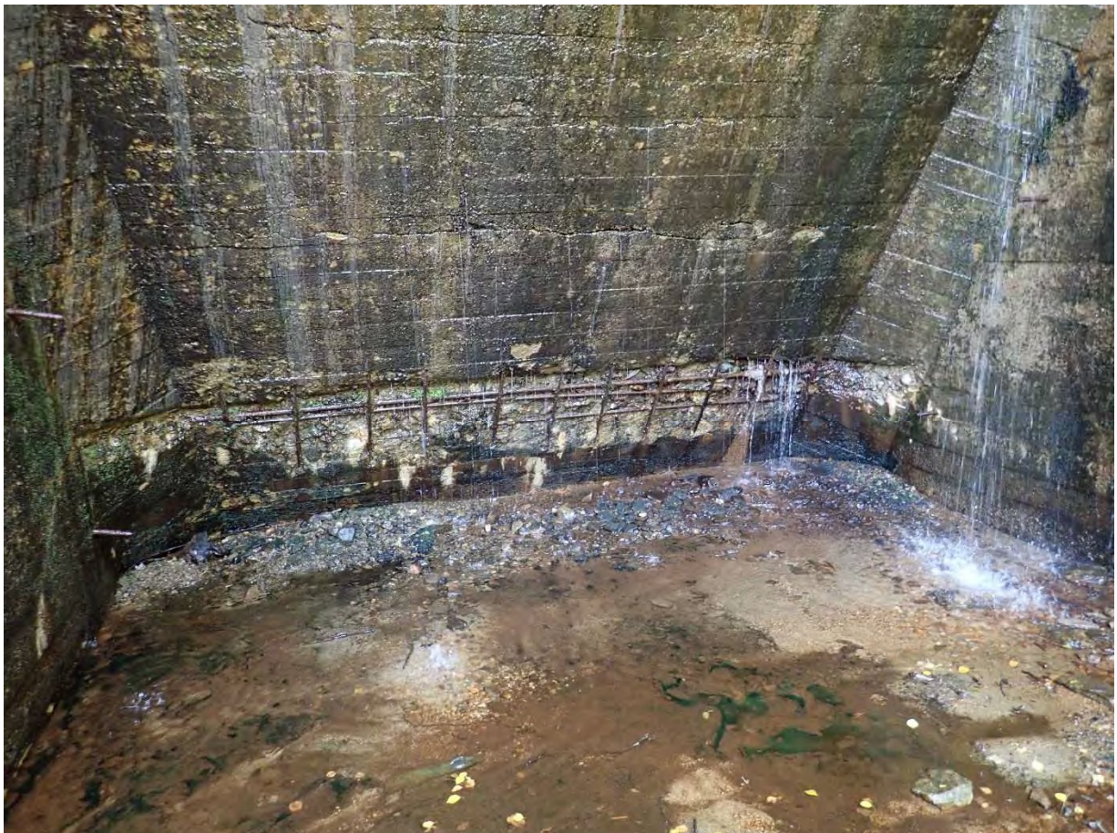
Figur 18. Skader på damplate sett fra nedstrøms.
