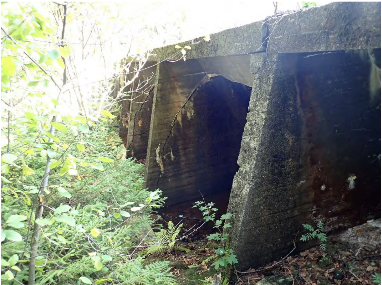
Figur 20. Skader på damplate og pilar sett fra nedstrøms.
