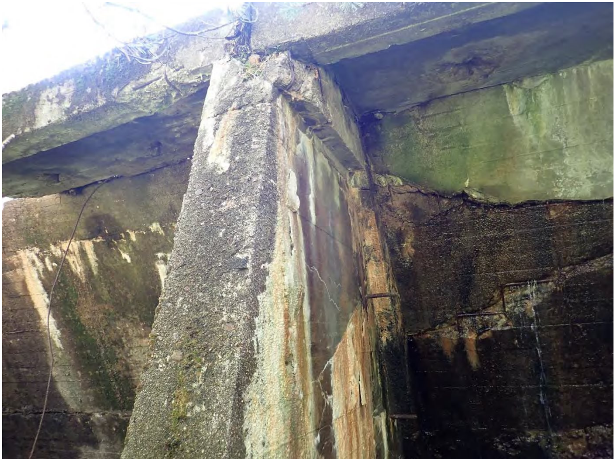
Figur 17. Skader på damplate og oppleggsknast sett fra nedstrøms.
