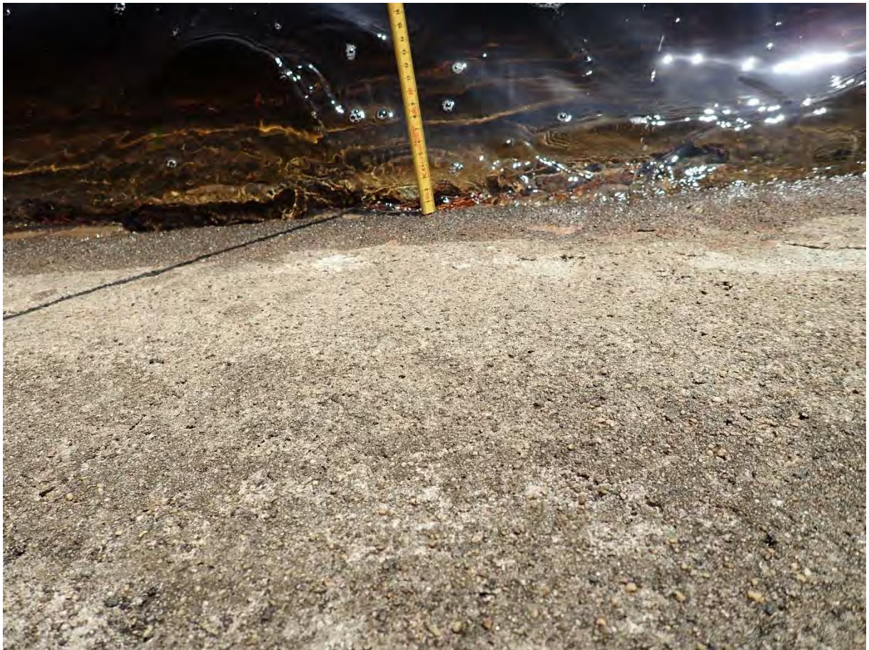
Figur 23. Forskyvning ved skade på damplate sett fra damkrone.
