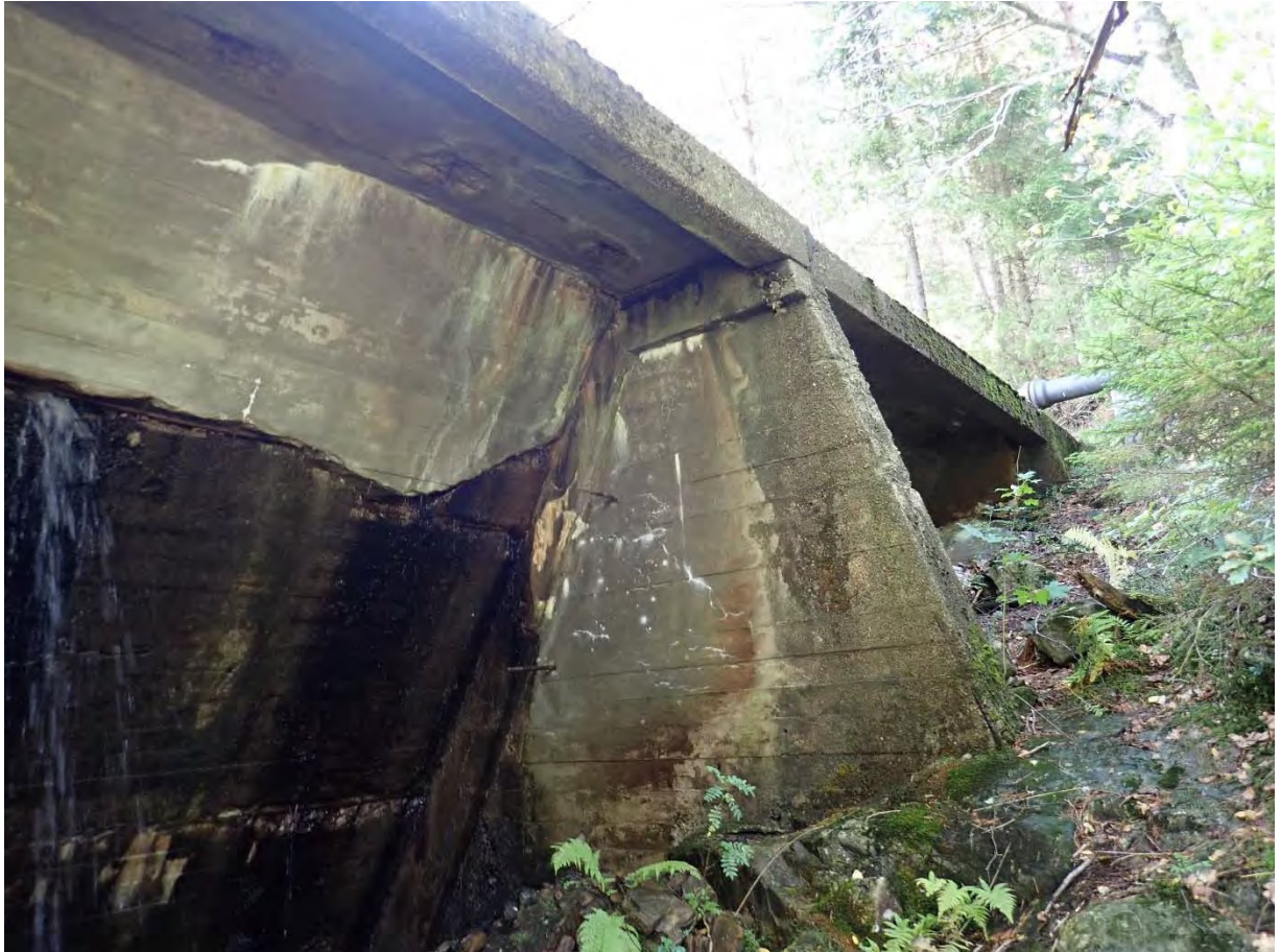
Figur 19. Skader på damplate sett fra nedstrøms.
