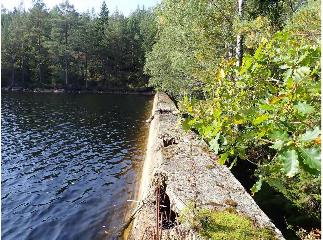
Figur 7. Skader på damkrone.
