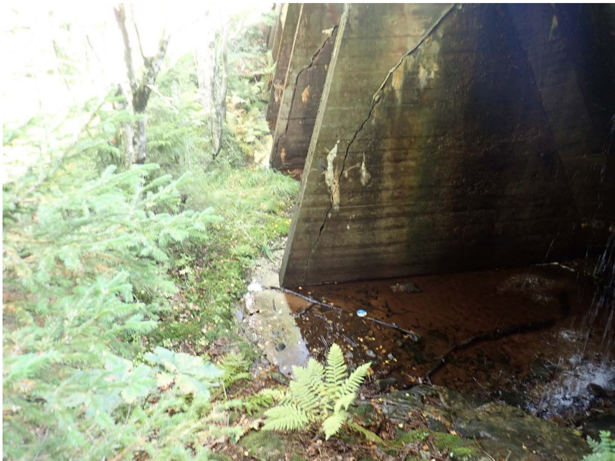
Figur 22. Skader på pilarer sett fra nedstrøms.
