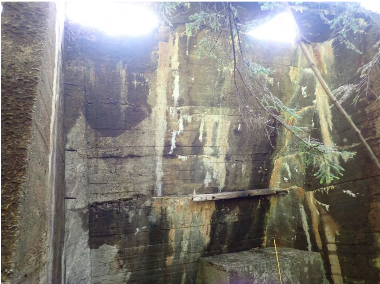
Figur 10. Skader på damkrone og damplate sett fra nedstrøms.
