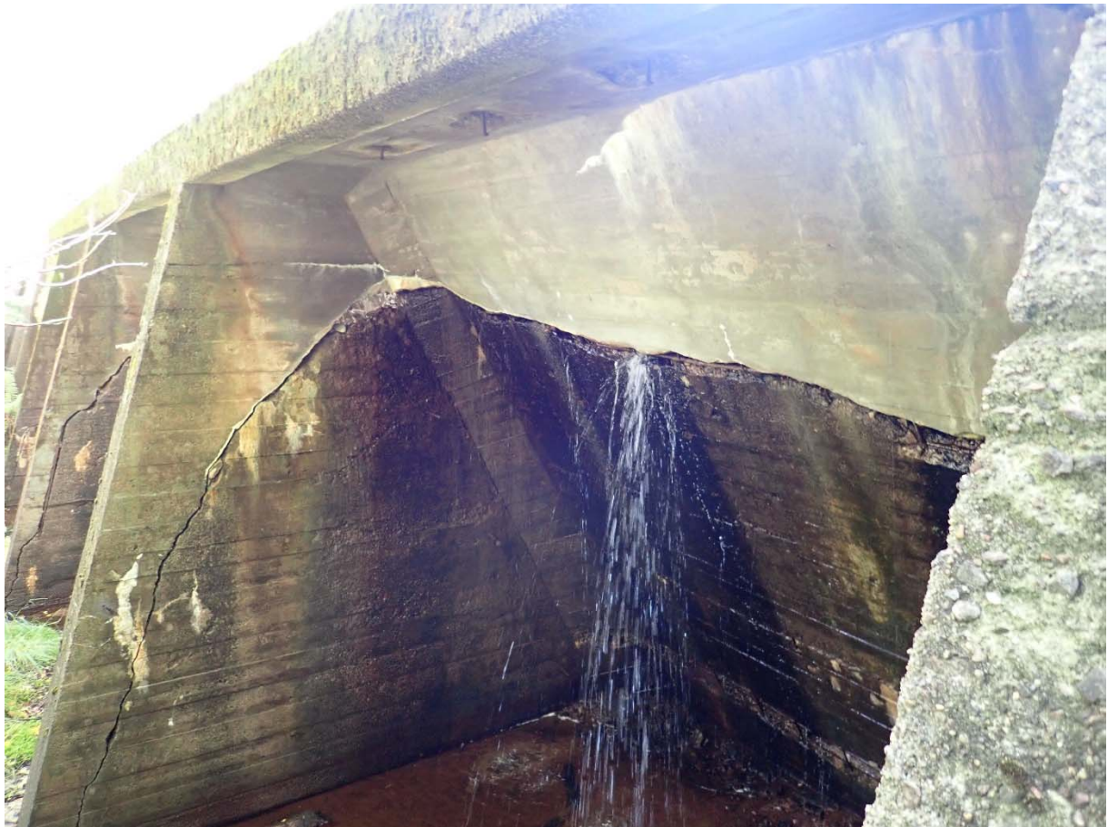
Figur 21. Skader på damplate og pilarer sett fra nedstrøms.
