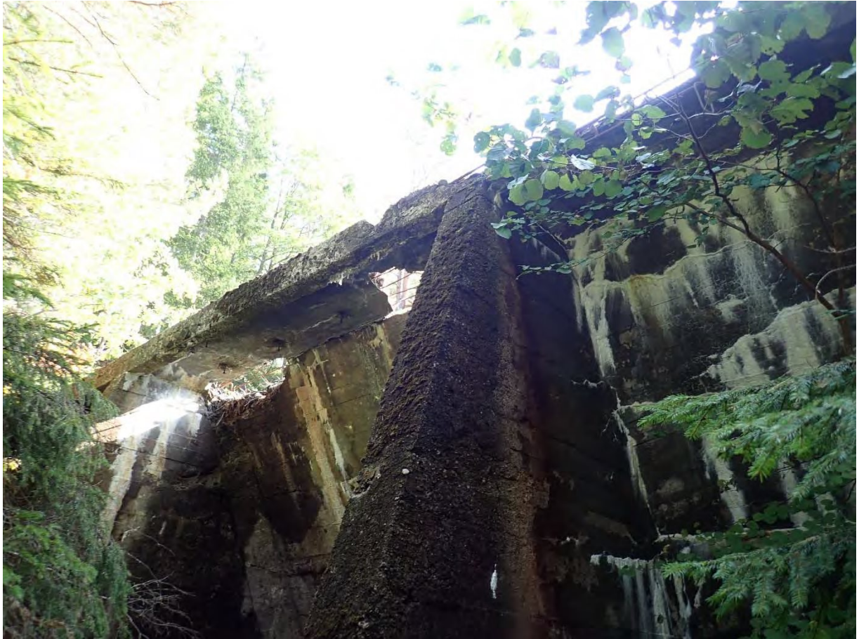
Figur 13. Skader på damkrone og plate sett fra nedstrøms.
