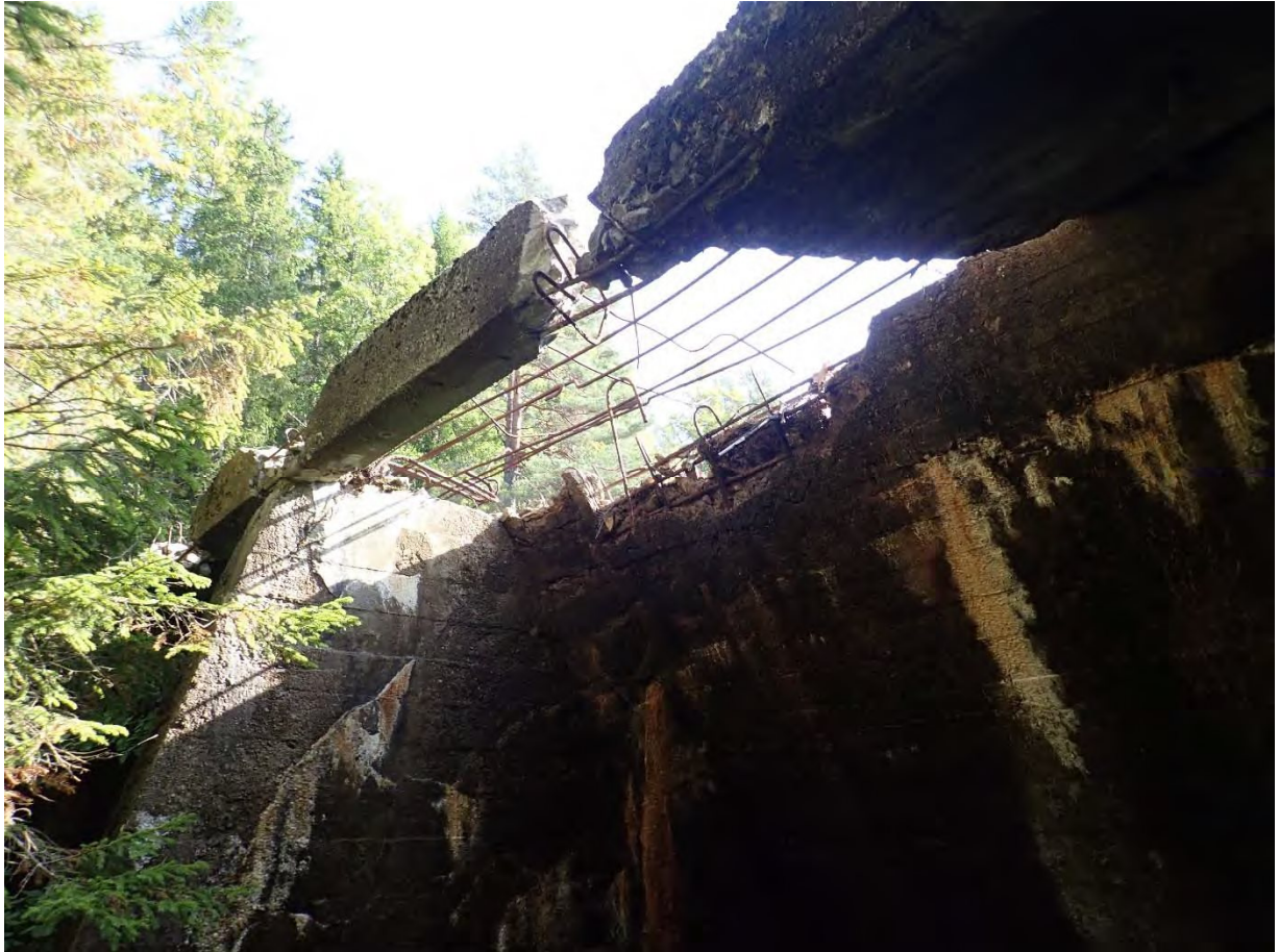
Figur 15. Skader på damkrone og plate sett fra nedstrøms.
