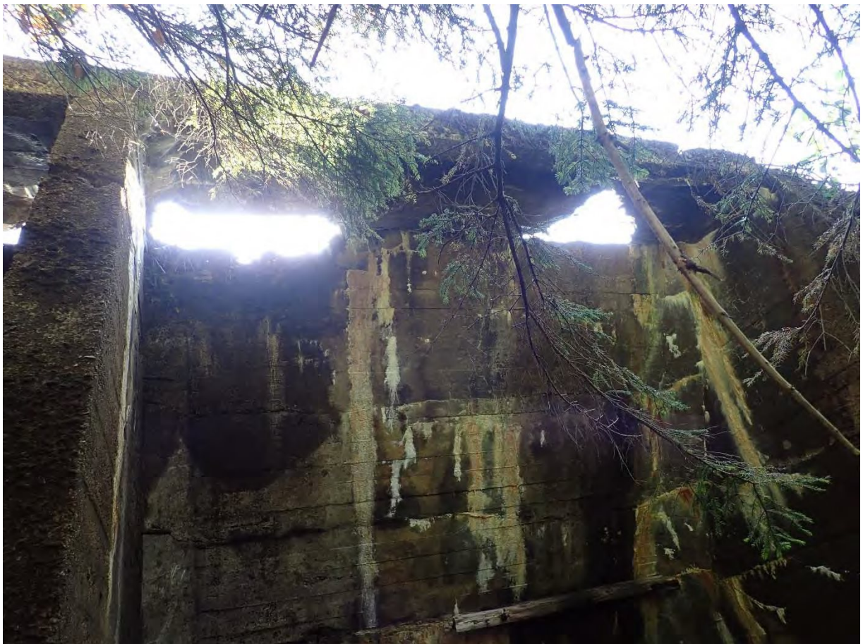
Figur 12. Skader på damkrone sett fra nedstrøms.
