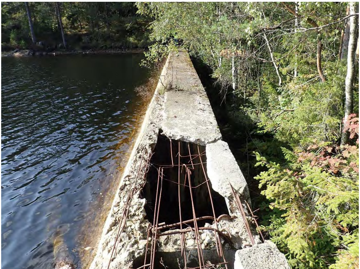
Figur 6. Skade på damkrone.
