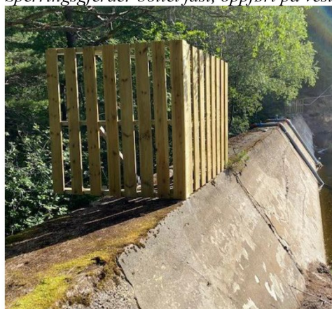
Sperringsgjerder boltet fast, oppført på vest- og østsiden av demning.
