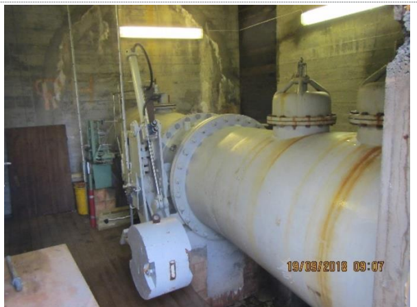
Rørbruddsventil i ventilkammer
