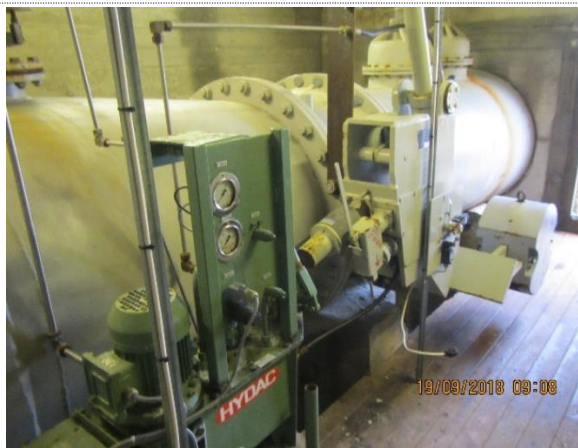
Rørbruddsventil i ventilkammer
