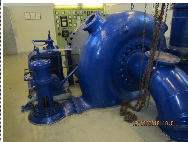
Turbin med sikkerhetsventil
