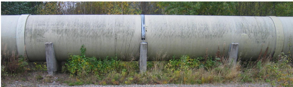
Figur 5-1 Eksempel på GRP-rør lagt på eksisterende betongfundamenter
