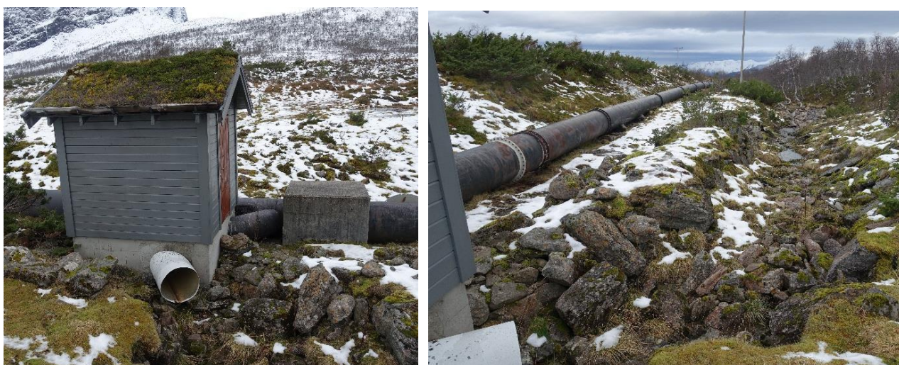
Figur 06. Eksisterande røyrbrottsventil er plassert i dette ventilhuset. Eventuelt flaumvatn blir ført ut i eigen kanal til det gamle elvelaupet frå Kvanndalsvatnet.
