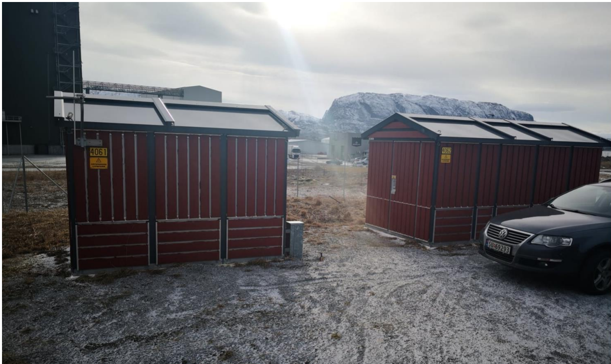
Bilde: Nettstasjoner der vindparken skal kobles til
