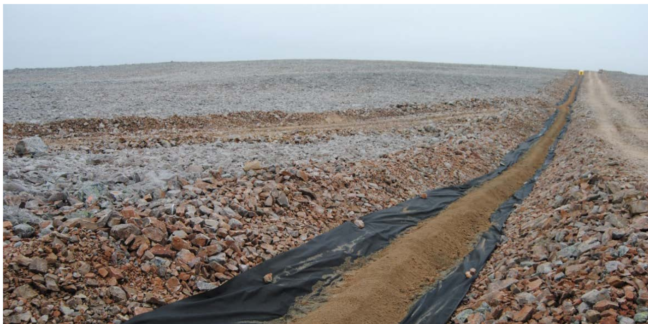
Figur 17 Her er kabelgrøfta lagt parallelt med midlertidig anleggsveg (nettilknytning Raggio I). Bildet viser at inngrepsområdet vil bli betydelig større enn dersom kabelgrøften legges i vegkroppen.
