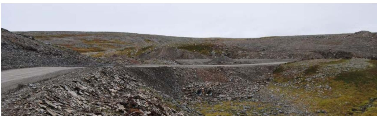
Figur 15 Bildet viser rør som er lagt i nedre del av fyllingen. Det er foretatt plastring rundt rørene før fyllingen for øvrig er lagt over.
