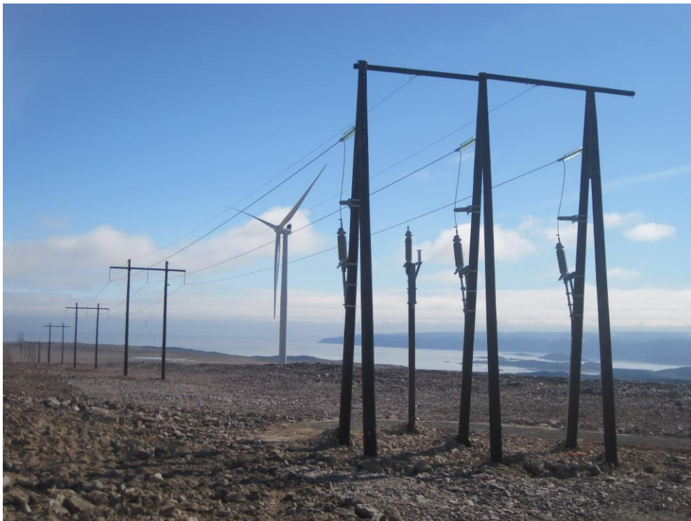
Figur 8. Raggovidda vindkraftverk, 132 kV nettilknytning. Kabelendemast fra Storvarden trafo.
