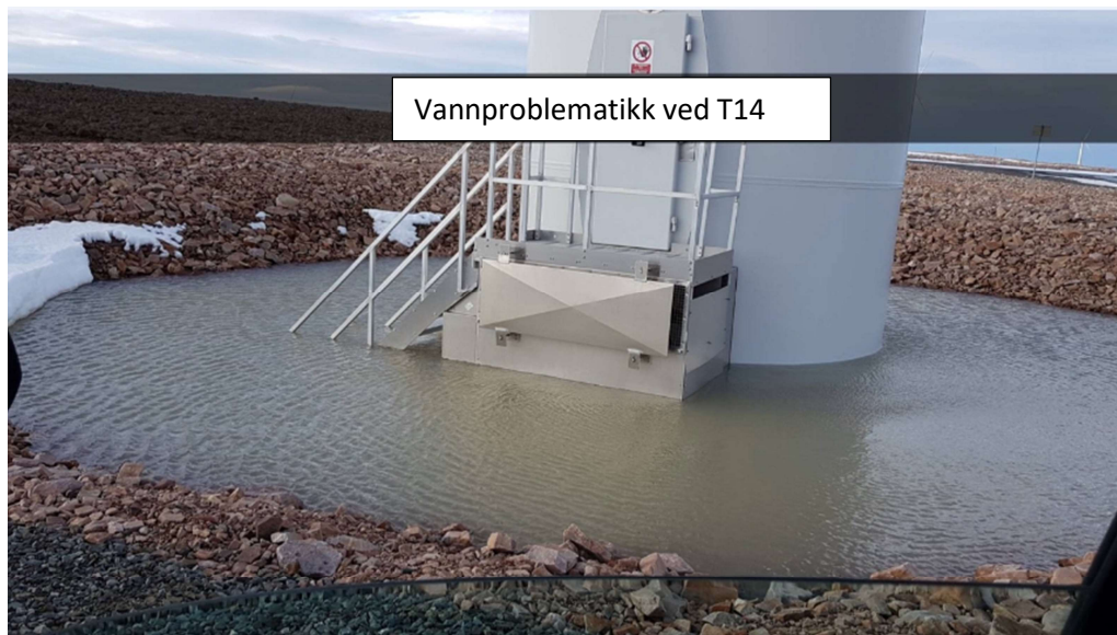
Figur 11 Turbin T14 med oppstuvning av vann. Atkomst til turbinen blir vanskelig og vifte under trapp stopper når vannet blir høyt nok.
