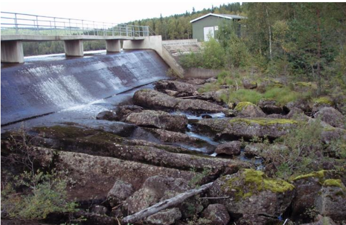
Figur 4: Dammen ved Bjertnessjøen. Dammen skal utstyres med anordning for minstevannføringslipp, noe den ikke har i dag.
