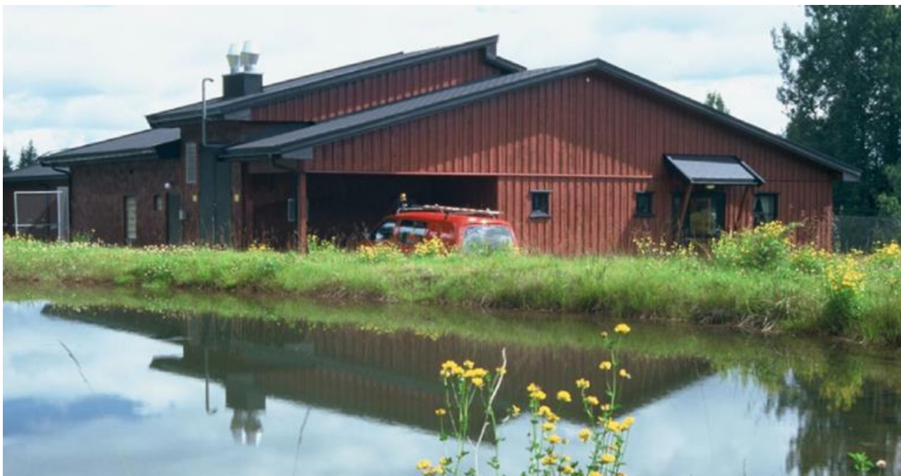
Bilde 2: Sjunken vannbehandlingsanlegg.
