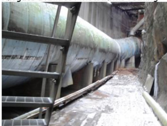
Rørgate avbildet i motstrøms retning
