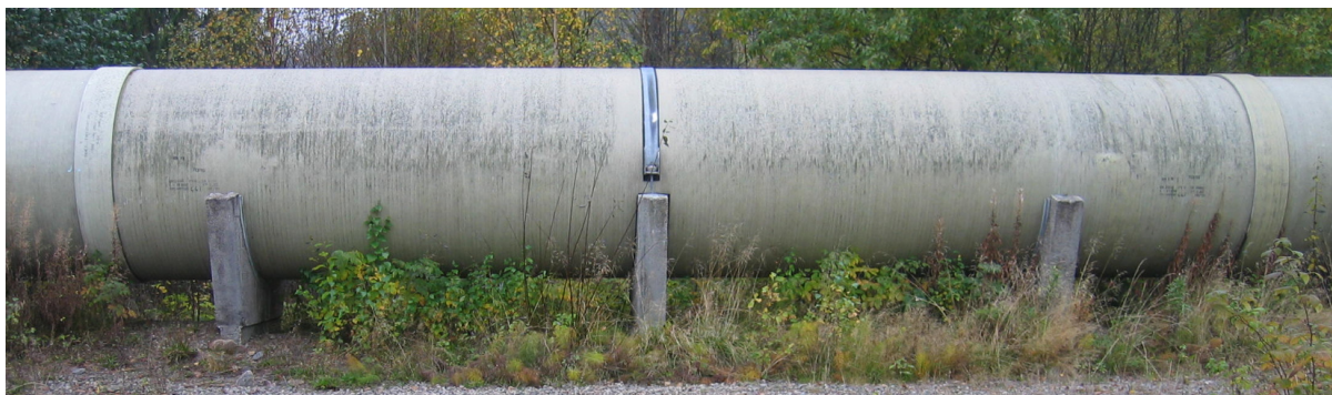
Figur 5-1 Eksempel på GRP-rør lagt på eksisterende betongfundamenter
