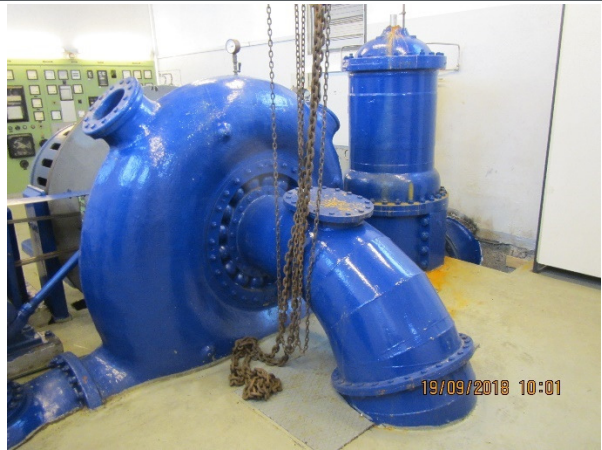
Turbin med hovedstengeventil
