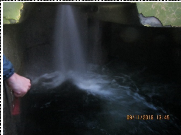
Avløp med lekkasje fra stengt sikkerhetsventil
