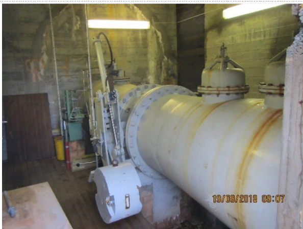
Rørbruddsventil i ventilkammer
