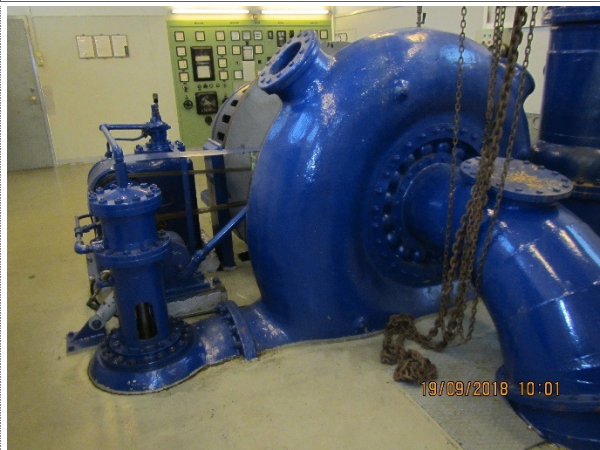
Turbin med sikkerhetsventil
