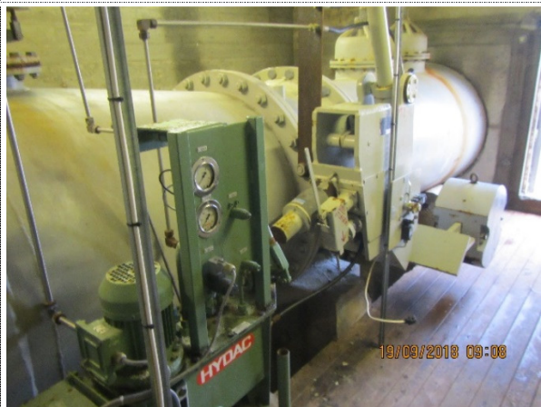
Rørbruddsventil i ventilkammer
