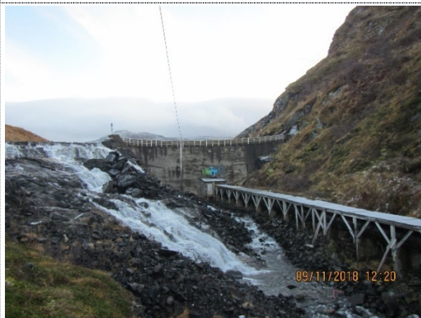
Dam Nedre Eggevatn med ventilkammer
