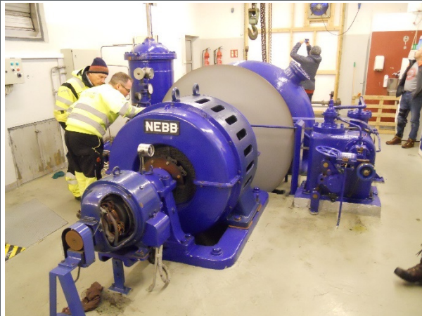
Generator, svinghjul og turbin
