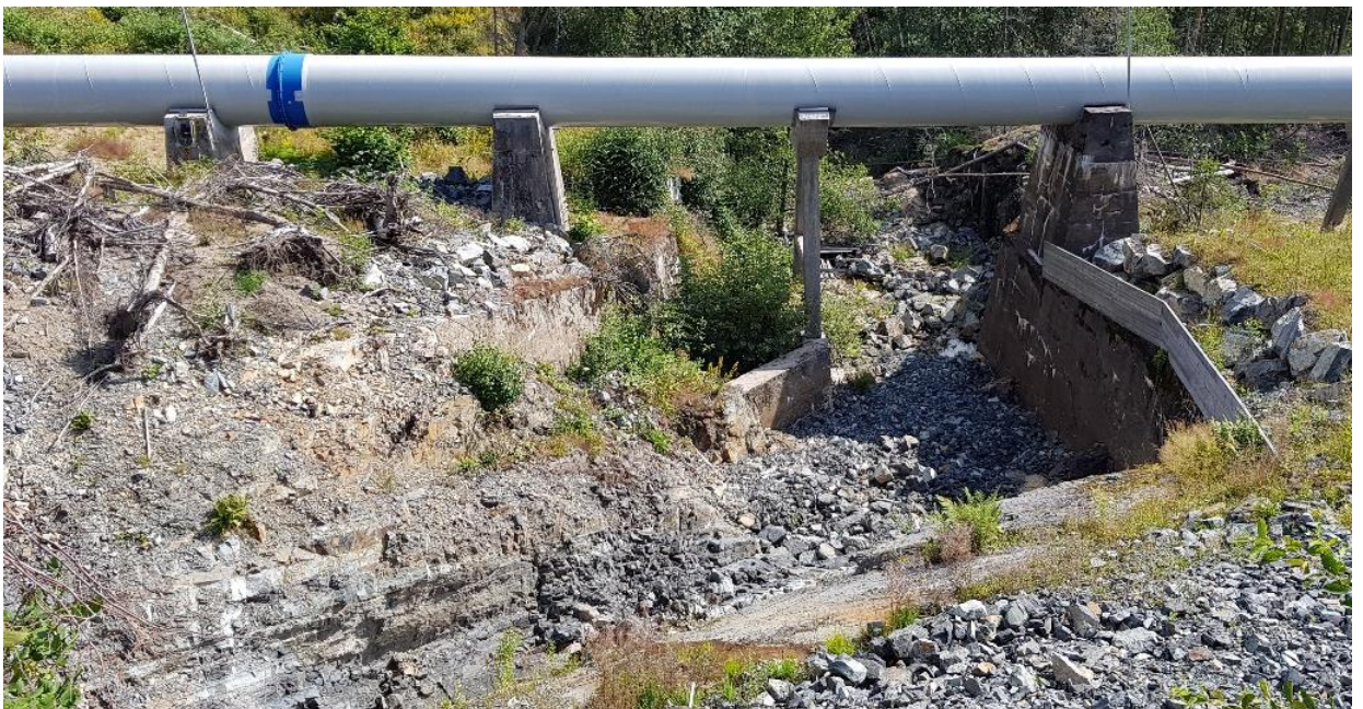
Figur 11. Det vestre elvefareet fra Modammen mot Slettevann. Røret leder vann til Mo kraftstasjon.
