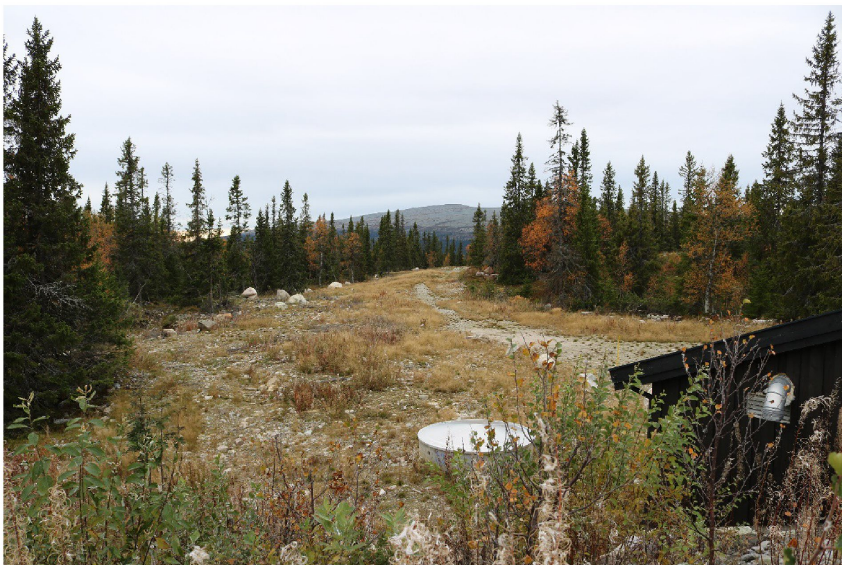
Figur 23. Øvre del av rørgatetraséen til Hylla kraftverk, sett fra dam Lille Hyllsjøen. Rørgata er nedgravd i hele sin lengde. Ventilhus kan sees i høyre bildekant.
