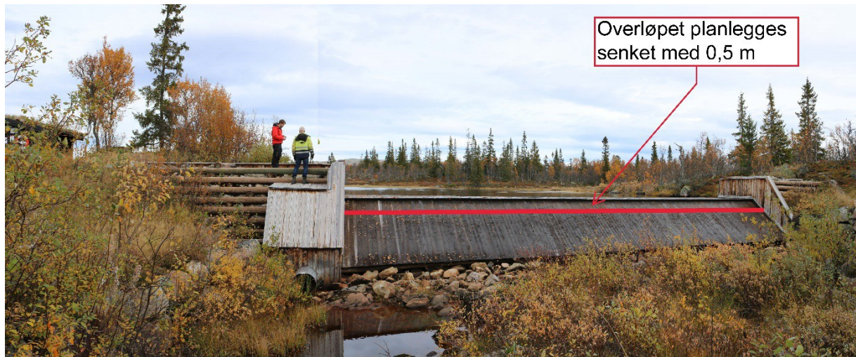
Figur 25. Tømmerkistedammen ved Store Hyllsjø planlegges bygget om ved å senke overløpet med 0,5 m. Den røde linjen illustrerer ca. høyde på overløpet etter ombygging. Det vil bli benyttet tilsvarende byggematerialer som i dag, slik at dammens estetiske uttrykk blir bevart.
