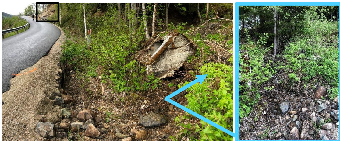
Figur 11 Oppstrøms flomløpet vises tydelige tegn på at vannet har funnet nye veier i terrenget og erodert. Svart firkant viser hvor bildet i figur 12 er tatt (Foto: Agathe Alsaker Hopland).
