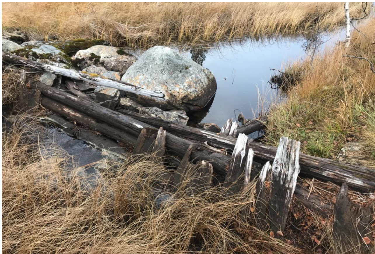
Figur 3: Eldre, provisorisk dam ved utløpet av Ulvtjønna. Dammen er i dag i svært dårlig forfatning og gir knapt noen oppdemming av vannforekomsten.
