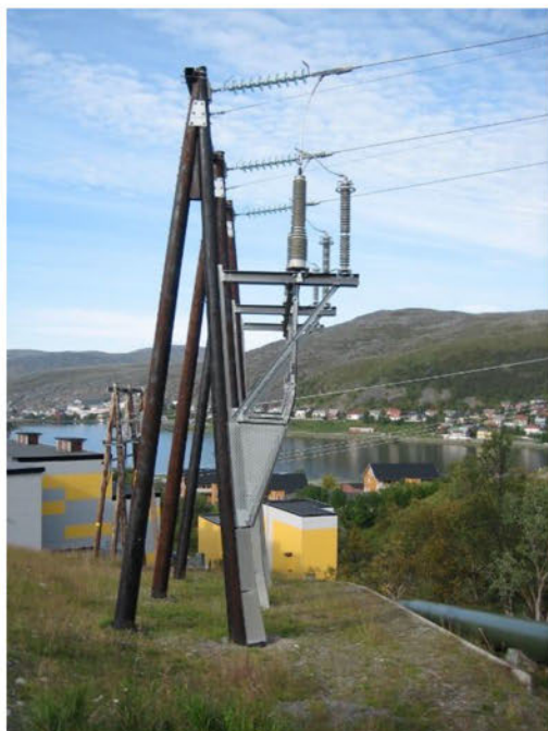
Figur 4-4. Eksempel på 3A kabelendemast. Foto Norconsult.
