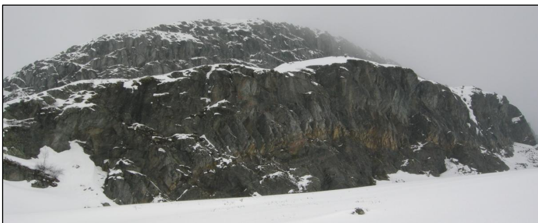
Figur 10: Bratt fjellside nedenfor Raudberkampen. Det ble observert en del løse blokker på toppen av og i selve fjellsiden.
