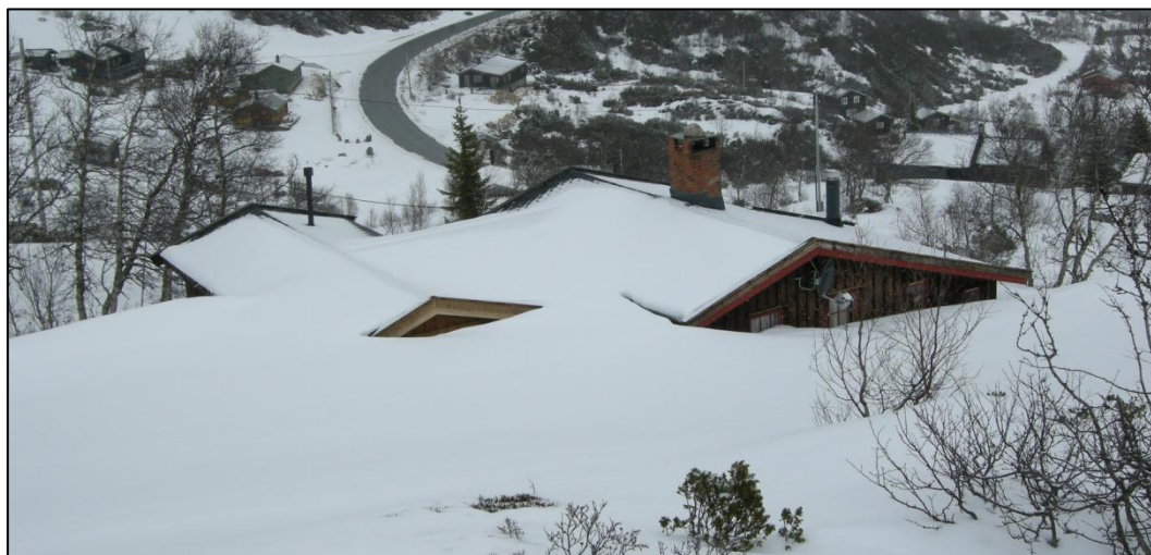
Figur 7: Snø som legger seg opp av vegger på bygg kan forårsake store skader på bygg. Fornuftig plassering av bygg i forhold til dette er derfor viktig, men er ikke behandlet videre i denne rapporten. Her mot Svingen.
