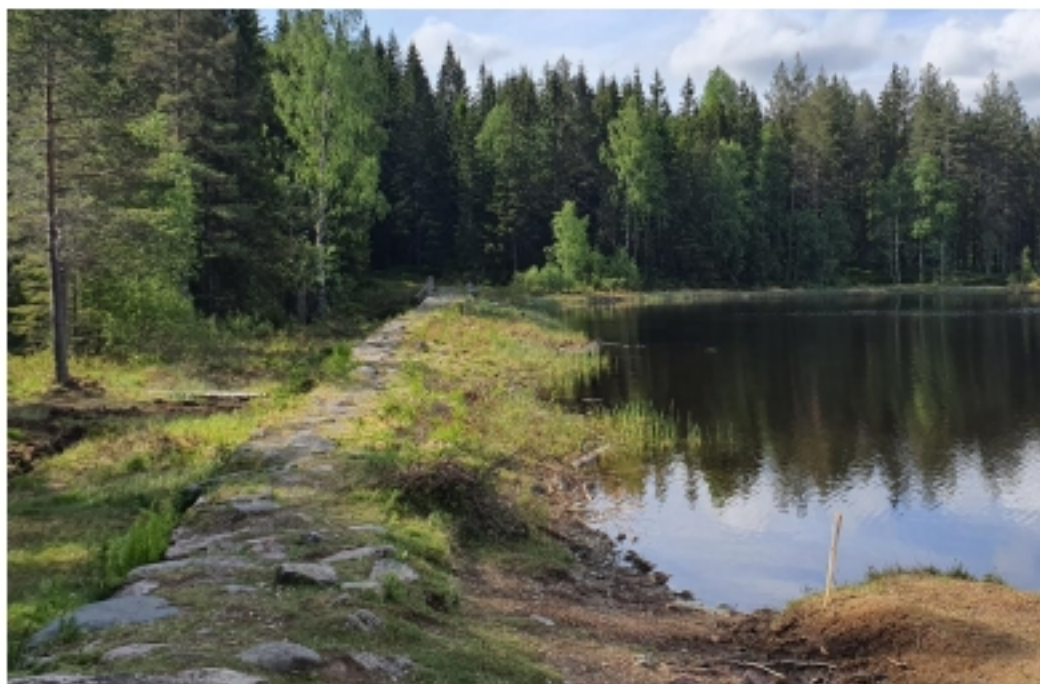
Figur 2: Dam Rottungen sett fra nord. En god del jord og myrmasse har lagt seg opp på vannsiden mens lekkasjer og tidvis overtopping av dammen sees i form av svært fuktig jord og graminidedominert feltsjikt på nedstrøms side.
