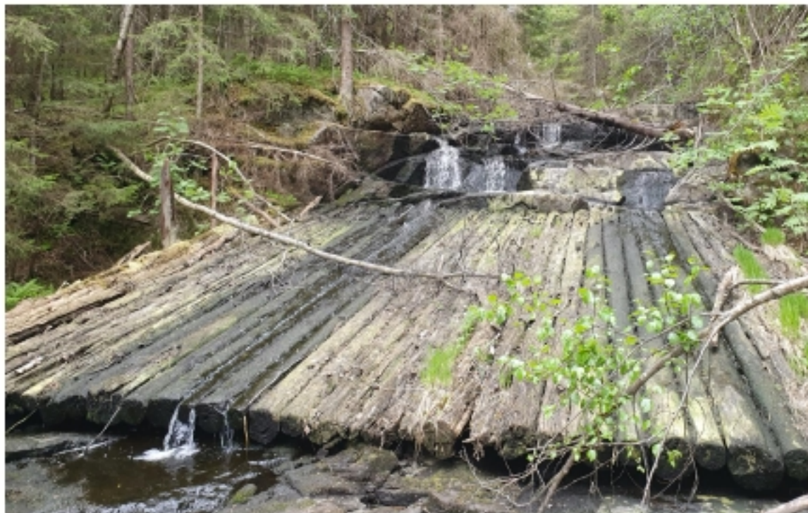
Figur 6: Gammelt fløtningsanlegg i Gåslungbekken, dette er trolig et fullstendig vandringshinder.
