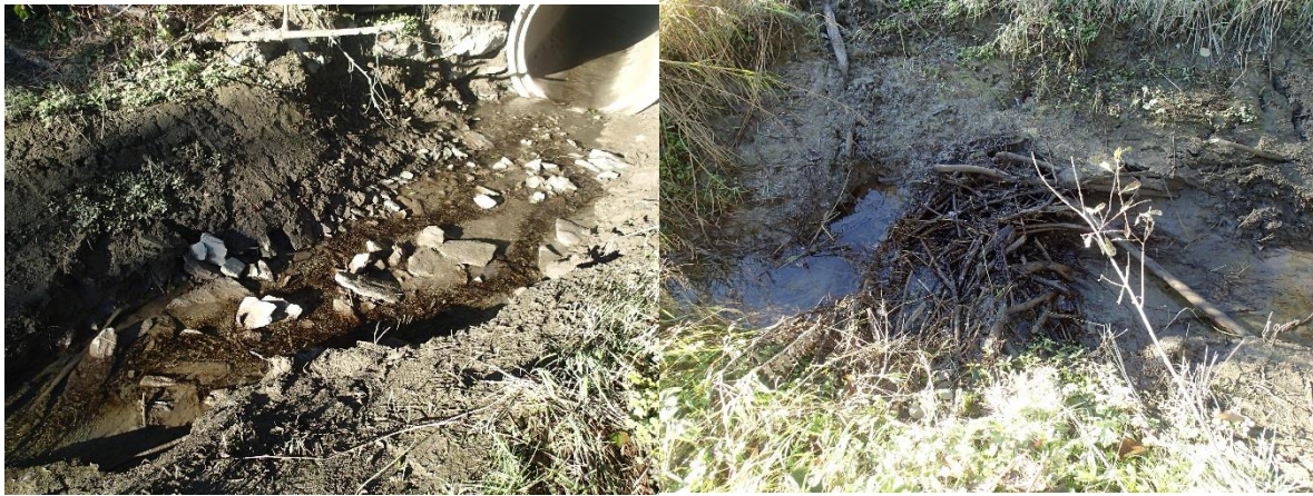
Figur 3-5 Bildet til venstre viser området rett oppstrøms kulvert under E39. Bildet til høyre viser typisk vandringshinder som har oppstått på strekningen.
