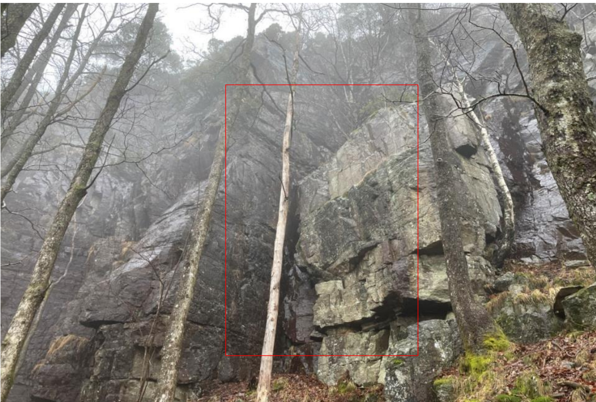
Bilde 12. Ustabil bergparti. Informasjonspunkt nr. 8 i vedlegg 5. Bildet er tatt mot nordøst.
