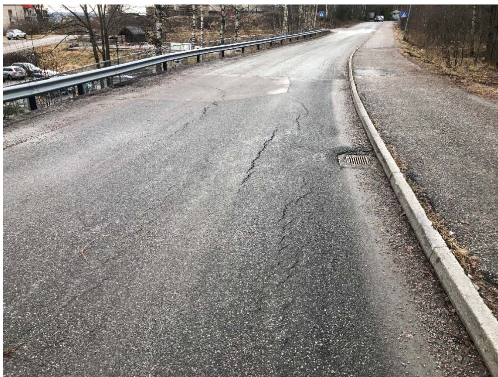
Figur 9. Oppsprukket asfalt i Vestheimvegen ovenfor barnehagen, bilde fra befaring den 10-02-2020.
