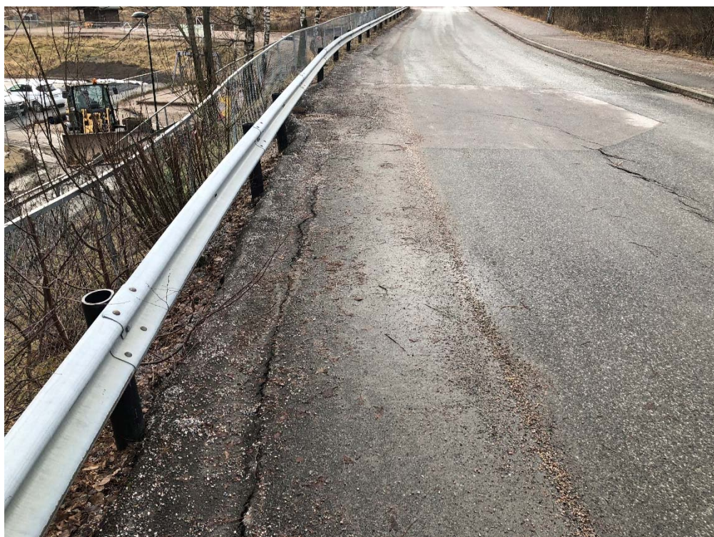
Figur 10. Figur 9. Oppsprukket asfalt i Vestheimvegen ovenfor barnehagen, bilde fra befaring den 10-02-2020.
