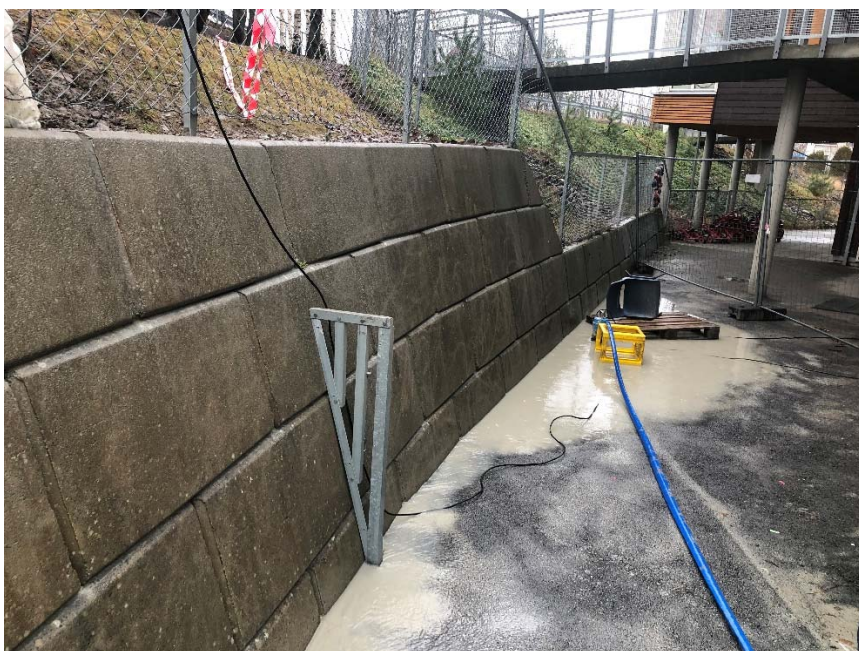
Figur 4. Finkornige masser foran støttemuren ved barnehagen, bilde fra befaring 29-01-2020.
