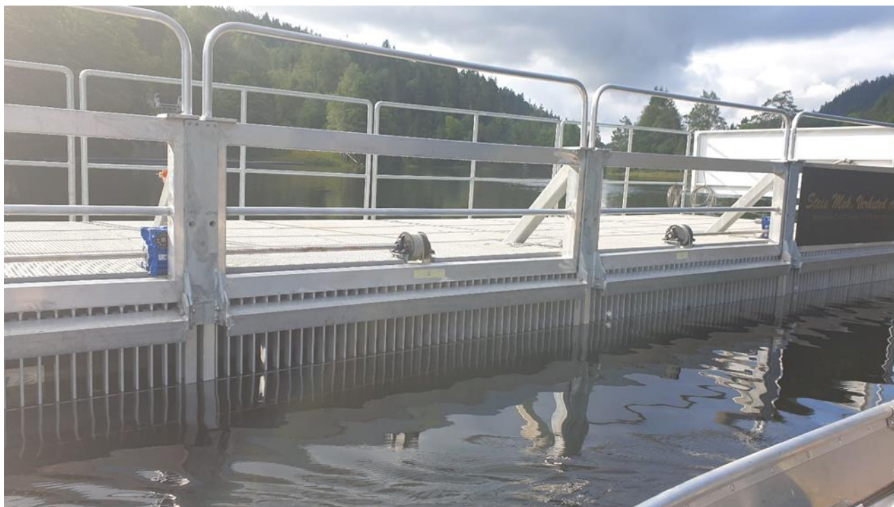
Figur 4-2 Oppstrøms side av ledegjerde i Mandalselva. Hvert panel har en lengde på 2,5 m og kan heves og senkes med vinsj. Grindrensker sees øverst på grindpanelene. (Bilde: Halvor Kjærås)
