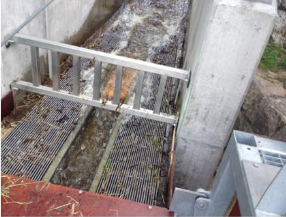
Figur 4-4. Finnrister i fiskeavlederen ved Herting kraftverk i Åtran. Formålet med rista er å skille ut nedvandrende fisk fra vannet, ved at fisken sklir oppå rista ned i en oppsamlingsrenne som føres til et oppsamlingsbasseng. Foto: Norconsult Sverige.
