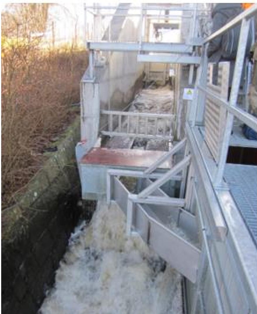
Figur 4-5. Finnrist i fiskeavlederen ved Herting kraftverk i Ätran. Formålet med rista er å skille ut nedvandrende fisk fra vannet, ved at fisken sklir oppå rista ned i en oppsamlingsrenne som føres til et oppsamlingsbasseng. Foto: Norconsult Sverige.
