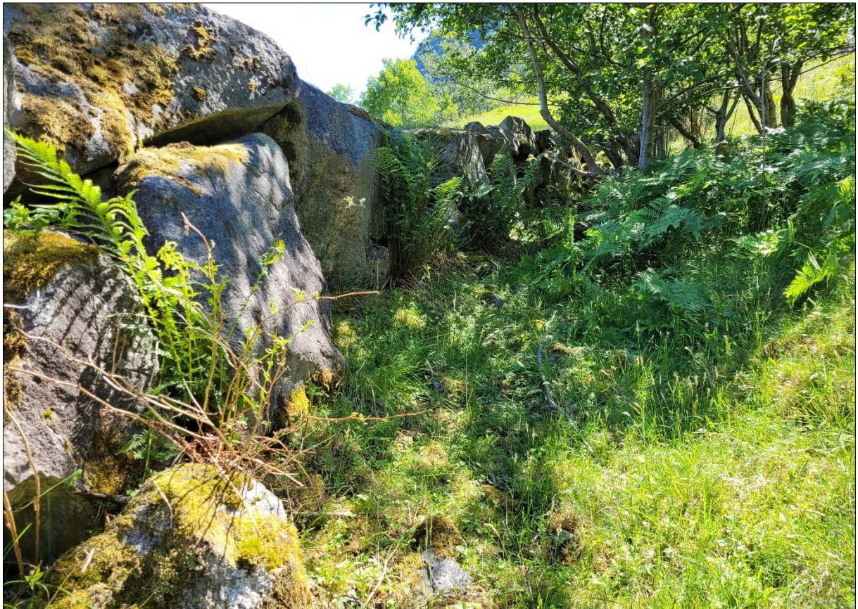
Figur 33: Steinmur bygd som skredsikring. Infopunkt 15.
