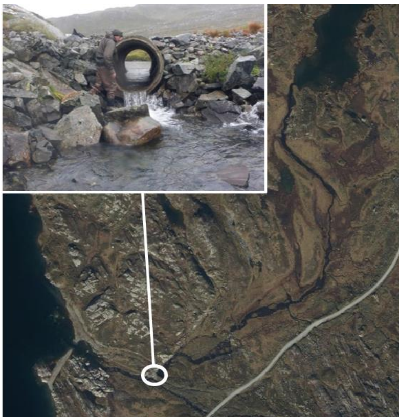
Figur 6-1. Kulvert under en eldre grusvei setter en effektiv stopper for oppvandrende ørret i den potensielt klart viktigste gytebekken til Sandvatnet. Utbedring/fjerning av kulvert vil gi gytefisk fra Sandvatnet tilgang til flere hundre meter «ny» bekkestrekning.
