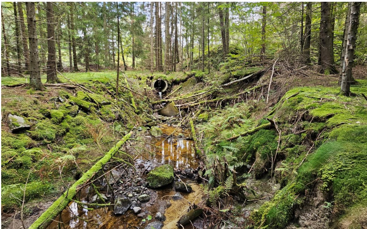
Figur 3-6 Kulvertutløp som går under Fv353. Sterk erosjon i marine masser har gravd mye i leirkantene, enden på kulverten har falt ned som følge av undergraving.
