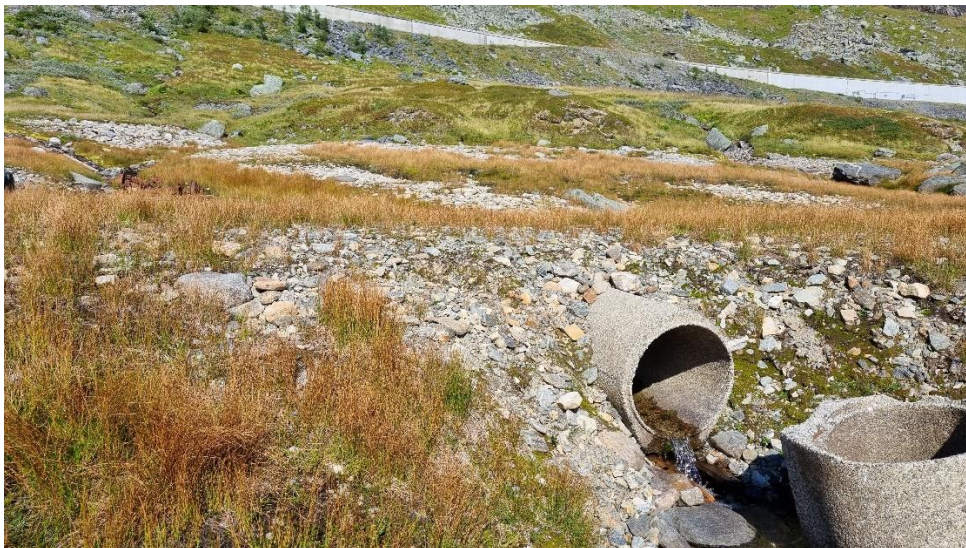
Figur 53. Rør ved bekk 9 som fungerer som vandringshinder i øvre del av reguleringssonen.
