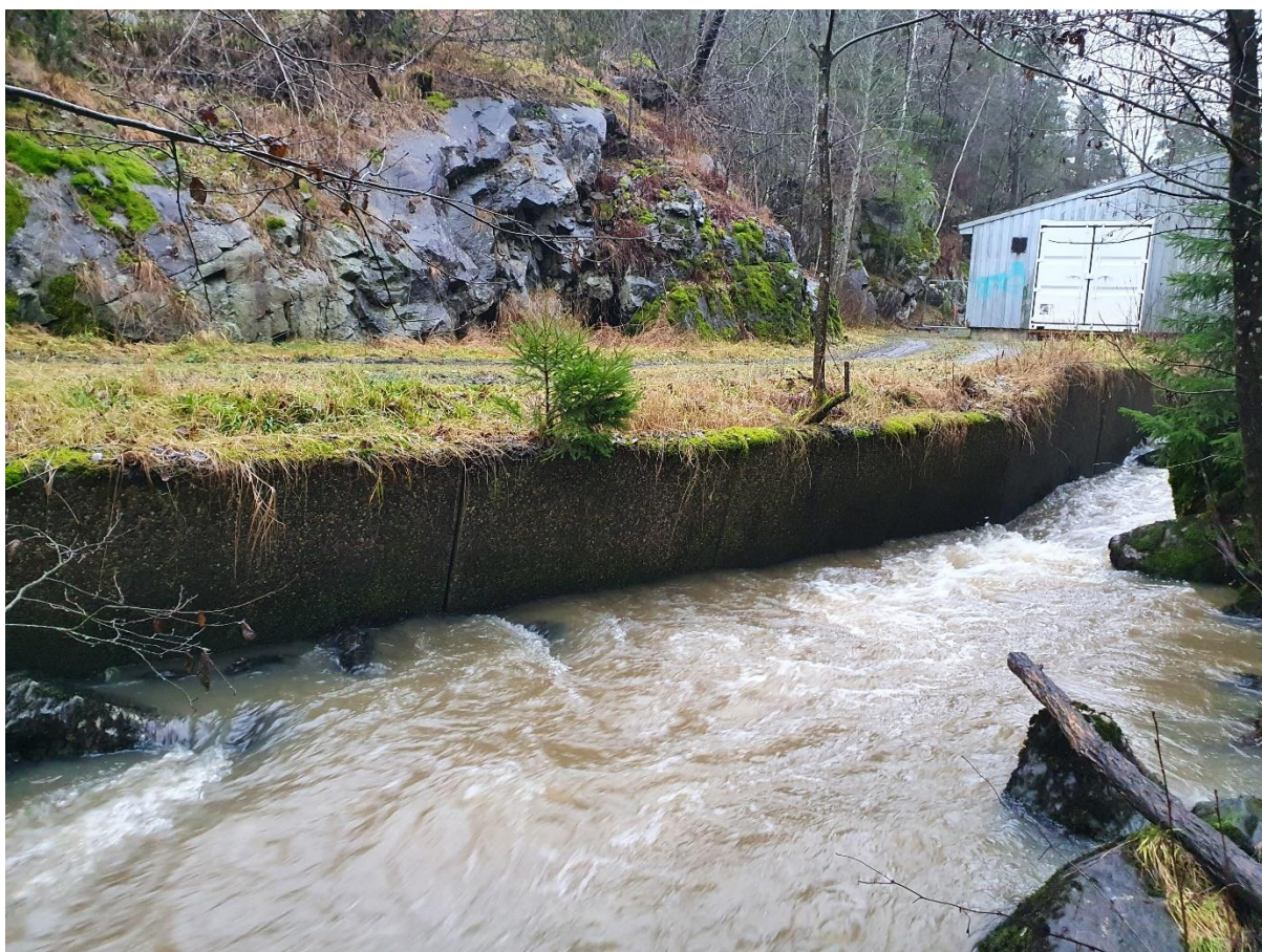
Støttemur, Haugbro pumpestasjon og adkomstvei. Dagens Ø600 btg sp ligger bak støttemuren. Bekkelukkingen skal forhindre at støttemuren og spillvannsrøret ikke raser ut ved økt anleggstrafikk.
