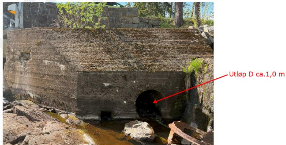
Figur 12: Utløp vannbasseng åpnes til før-2018
