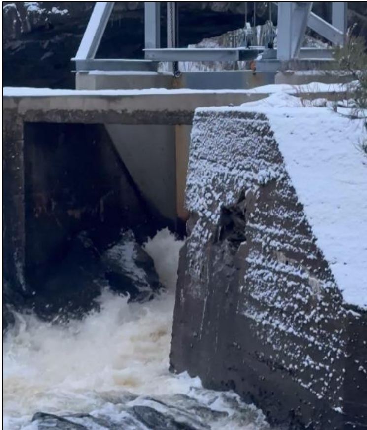
Figur 15: Skade på bassengvegg (eksisterende)
