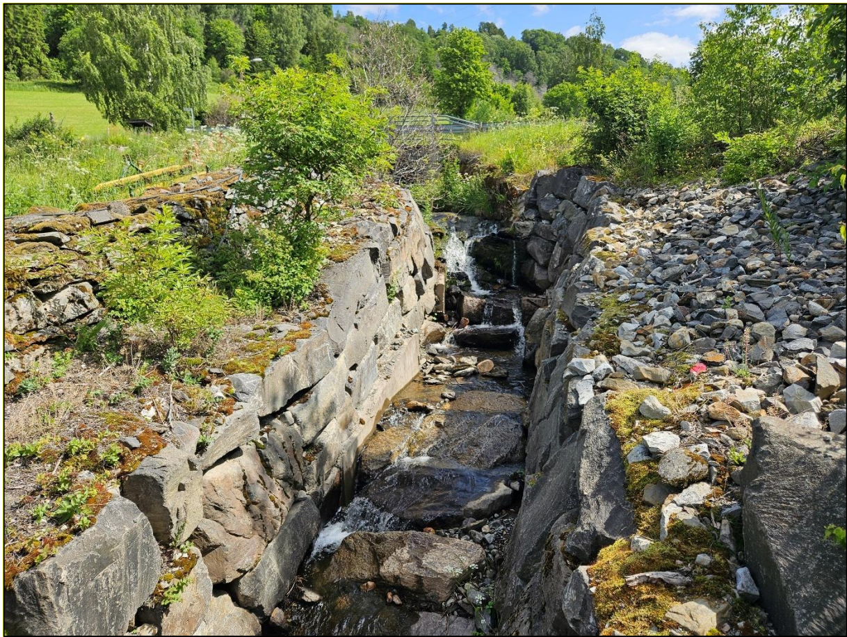
Figur 5: Bekkeløpet til Høvrebekken der det svinger vest for rett vest for Øyer kirke. Det var i dette området kulvertene gikk tette i 2014 ifølge oppdragsgiver.
