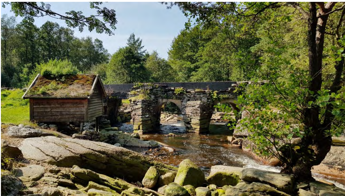
Figur 9 Hellandsbrua, over Hellandselva like ed Opsangervatnet, er et av kulturminnene langs postruten. Dette er en stor bro, oppmurt med tre løp, som ble restaurert på 2000-tallet. Foto: Sweco
