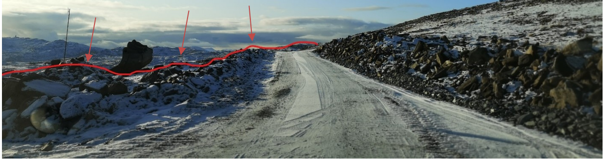
Bilde 6: Avskavede masser ligger som ranker langs veien. Må fjernes eller tilpasses eksisterende terrengformer.
