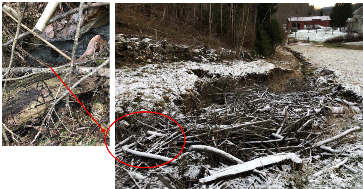
Figur 5-5: Erosjonsgrøft nedenfor Modalsveien
