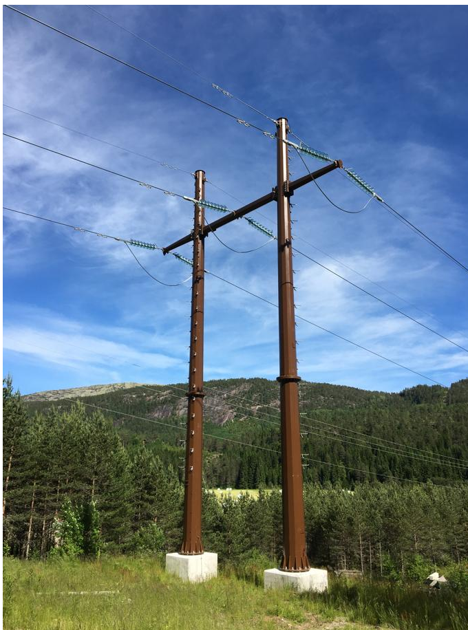
Figur 2-7. Stålrørmast i rasutsatte områder. Rasfundament med høye betongfundamenter (1 til 4 meter avhengig av raslaster).
