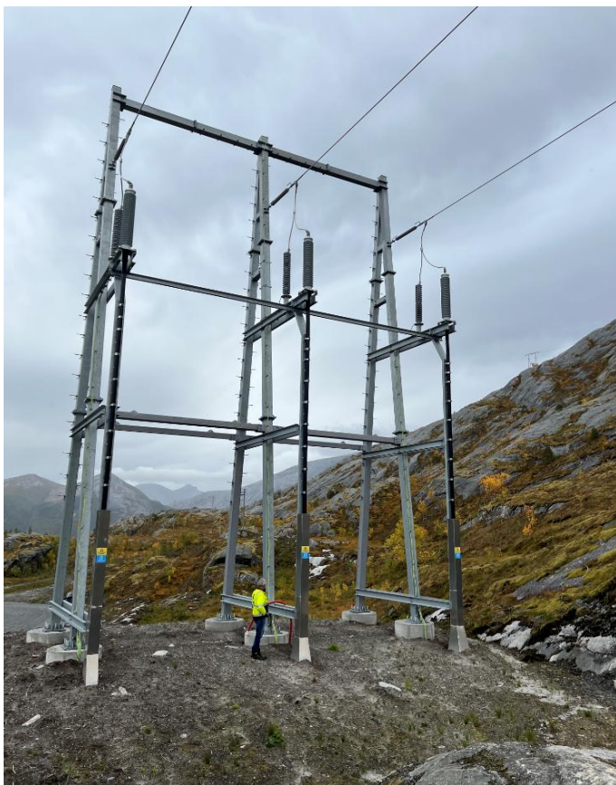
Figur 2-6. Kabelendemast (A3) i stål. Foto Norconsult.
